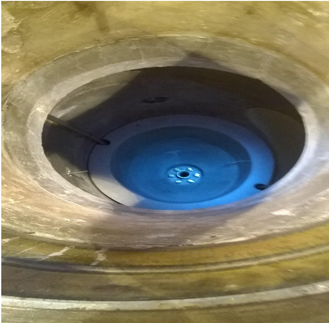
Kuva 10. Kaasuttimen sisäosa, jossa näkyy 1. ja 2. vaiheen välissä oleva vaippa ja yhdysputki.
