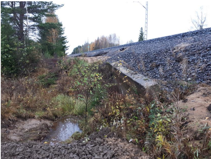
KUVA 2. Vanha tukimuuri siirtynyt. Kuvaaja: Veli-Matti Laasonen 2017
