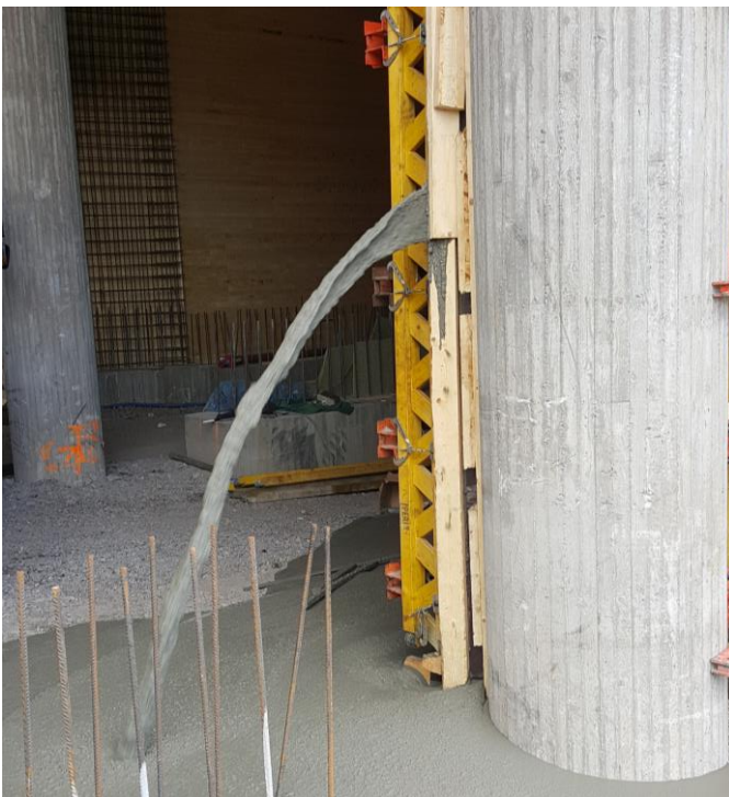
Kuva 18. Sivusta pettänyt seinämuotti
