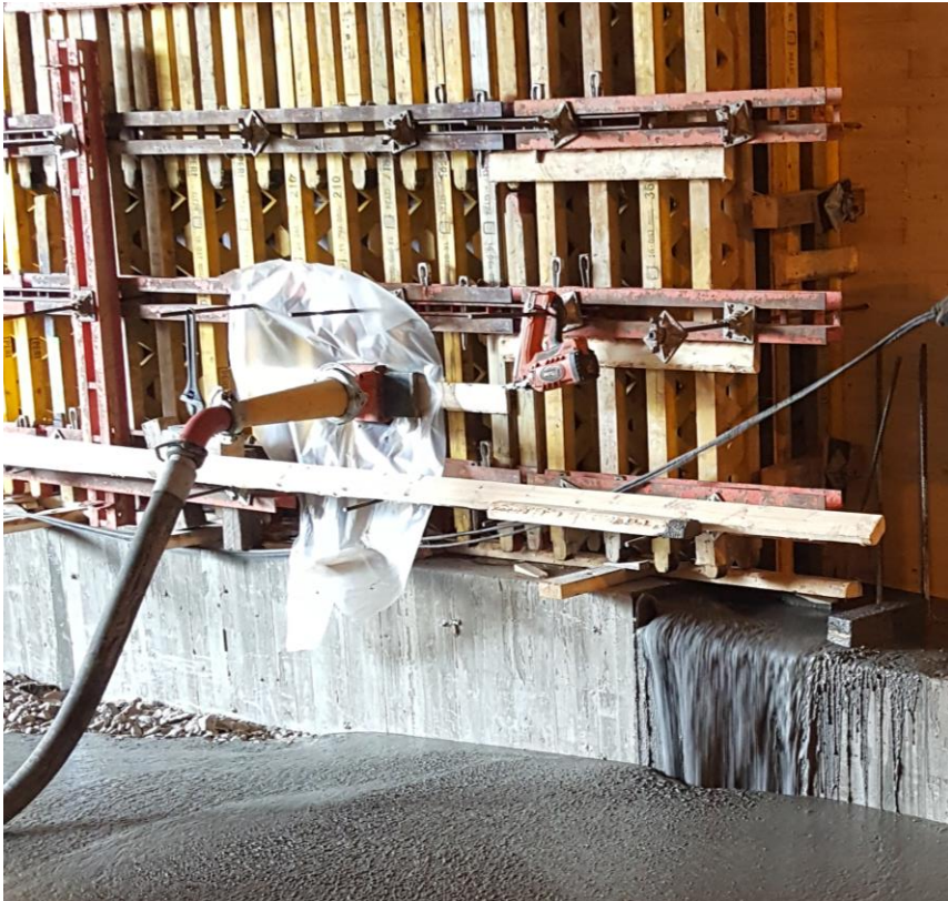
Kuva 17. Alareunasta pettänyt seinämuotti, GRK, Pasila, Teollisuuskatu
