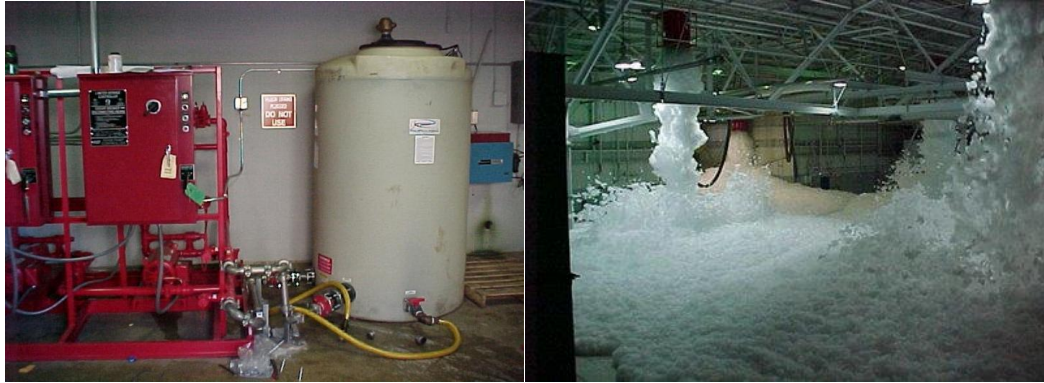
Kuva 13. Vaahtosammutusjärjestelmä (Daily owned)
