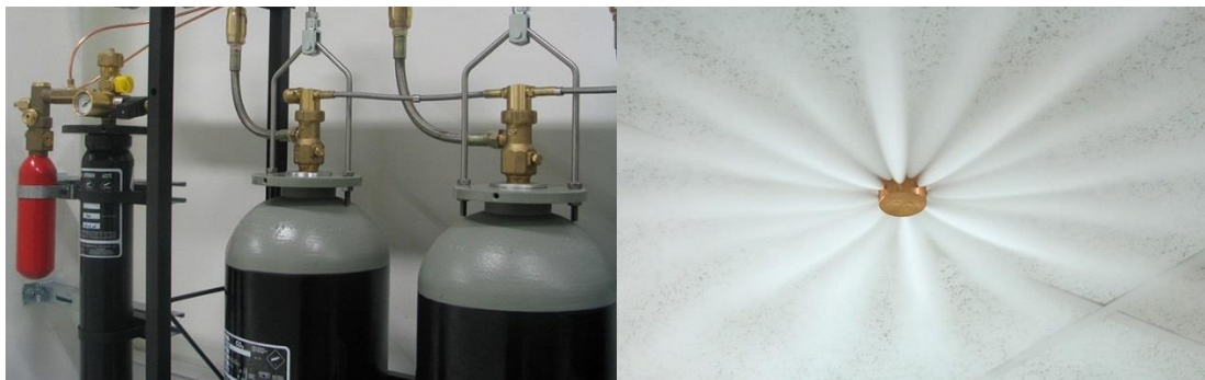
Kuva 14. Hiilidioksidi sammutusjärjestelmä ja suutin (YTM-Industrial)
