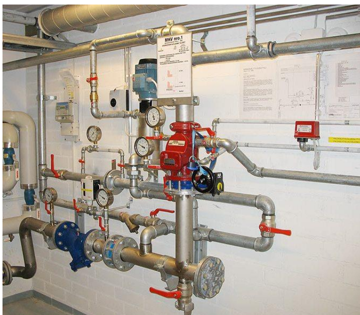
Kuva 8. Vesisprinklerijärjestelmä (Jypro Oy)
