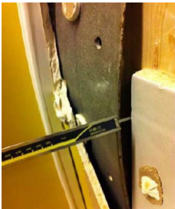
KUVA 36. Teräslevyn kosteusvaurioituminen (Lahtela 2015)
