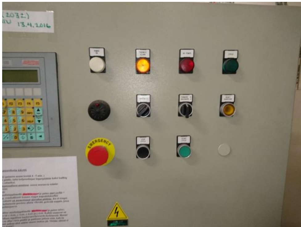
Kuva 9. Keskuksen kannessa sijaitsevat kytkimet ja merkkilamput
