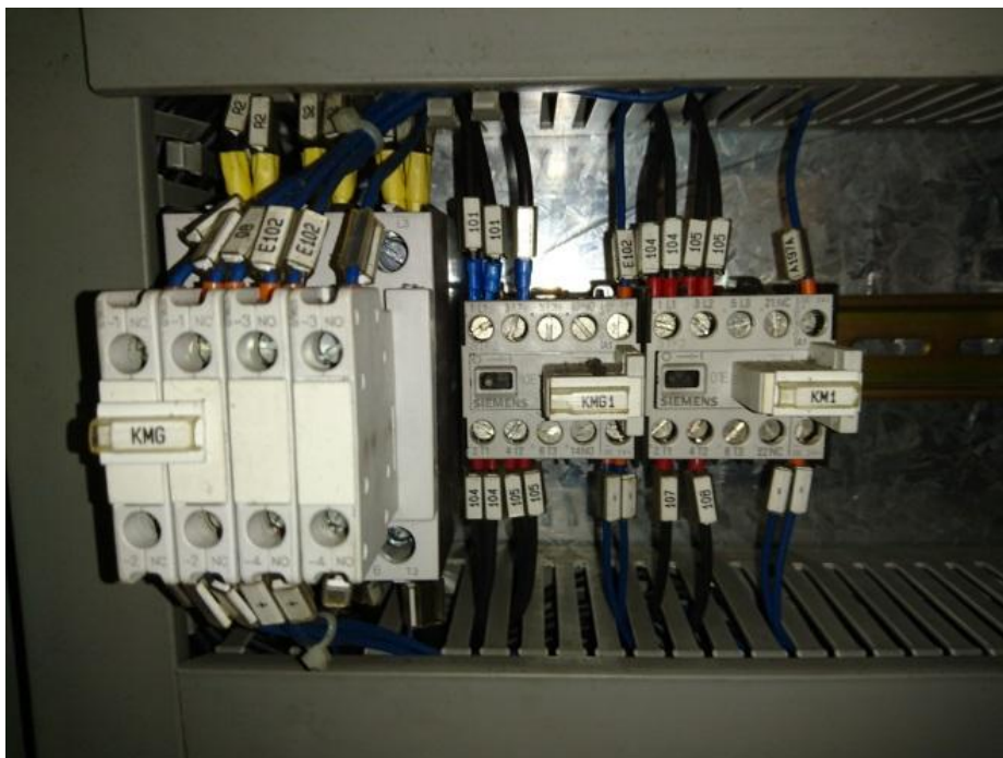
Kuva 10. Päävirtapiirin kontaktorit. Päävirtapiirin kytkentöjä ei muutettu vaan hyödynnettiin vanhoja kytkentöjä ja ohjauksia.
