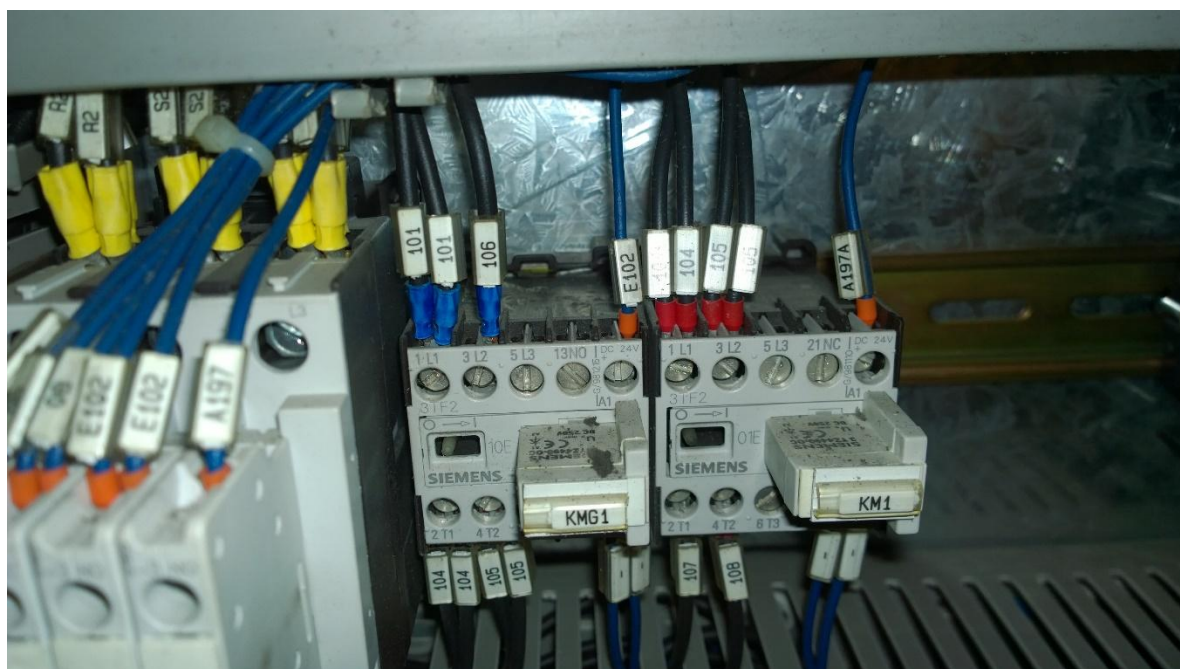
Kuva 20. Kaapelinmerkintä on toteutettu hyvin keskuksessa
