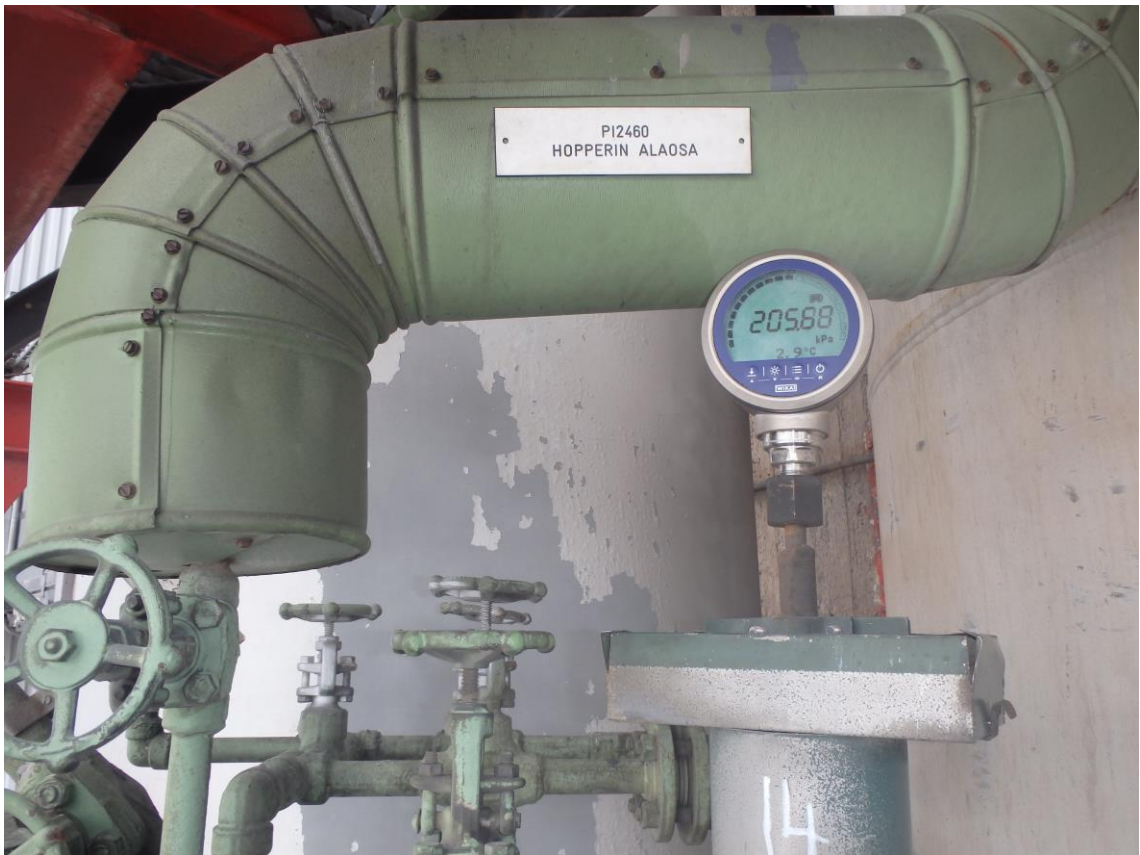
Kuva 16. Analogisen painemittarin tilalle on asennettu digitaalinen tarkkuuspainemittari mittauskierroksella.
