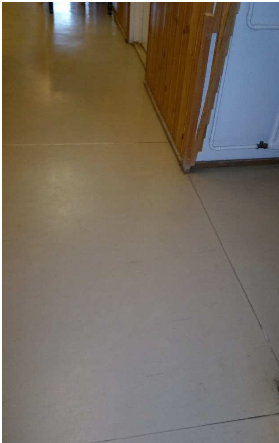
Kuva 1. Kiinteistön lattiamateriaalin kulumat.
