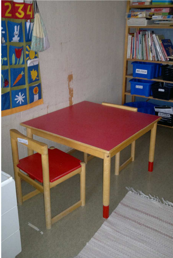
Kuva 2. Päiväkotikiinteistön seinämateriaalin kulumia.
