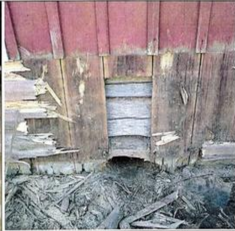
Alin hirsi oli makuuhuoneiden kohdalta vaurioitunut
