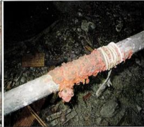
Putken tiiveydessä puutteita, josta on päässyt vettä välipohjan eristetilaan.
