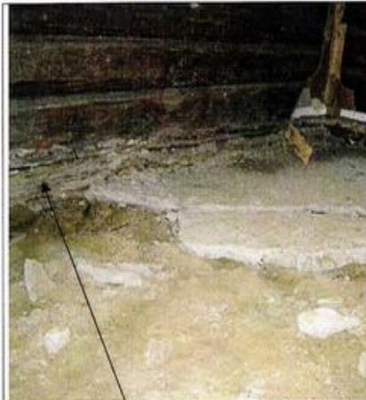
Alin hirsikerros on lahonnut. Makuuhuoneiden 1 ja 2 lattiassa oli kosteutta villa eristeessä. Kuva purkuvaiheesta.
