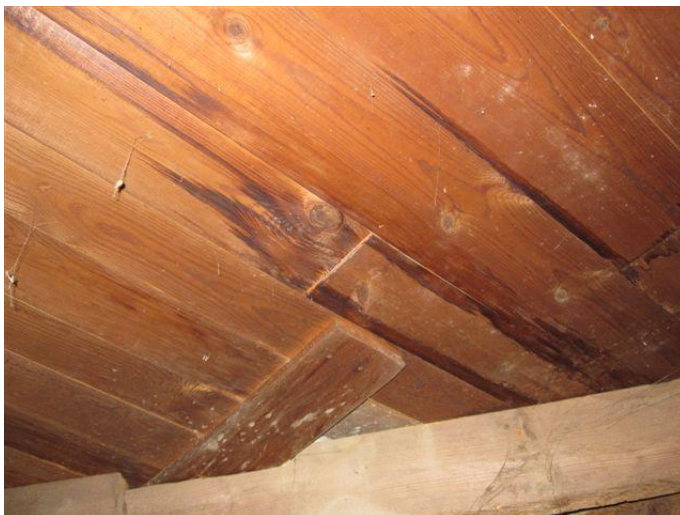
KUVIO 13. Kosteuden aiheuttamia jälkiä välipohjassa
