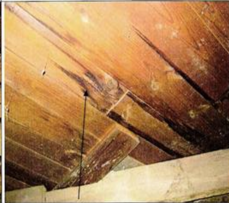
Olohuoneen katossa kosteuden aiheuttamia jälkiä
