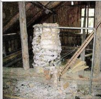
Vanha paisunta-astia yläpohjassa
