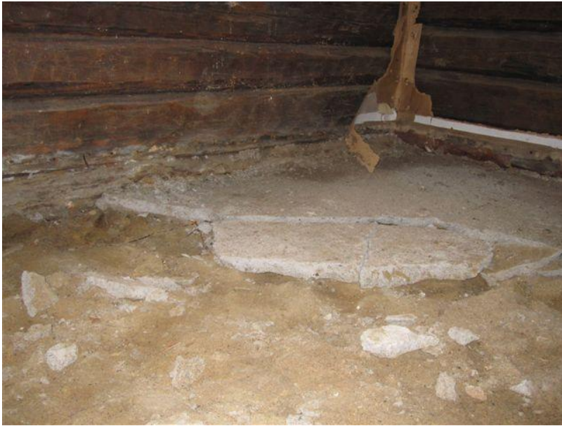
KUVIO 9. Makuuhuoneen lattia, joka oli kastunut ulkopuolisista vesistä
