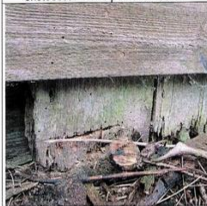
Ulkoverhouslauta oli paikoin kiinni maassa ja se oli lahonnut alapäästään.
