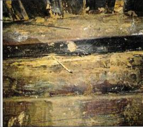
Pinkopahvin purkamisen jälkeen havaittiin seinässä lahovauriota piipunjuuressa
