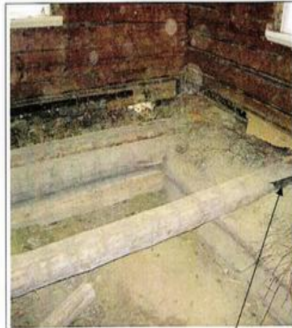
Multiispennkiperustus. Maakosteus on vaurioittanut lattiarakenteen maata vasten olevia hirsikoolauksia
