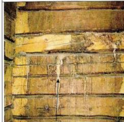
Virtsan hajua olohuoneen seinässä pinkopahvin alla.
