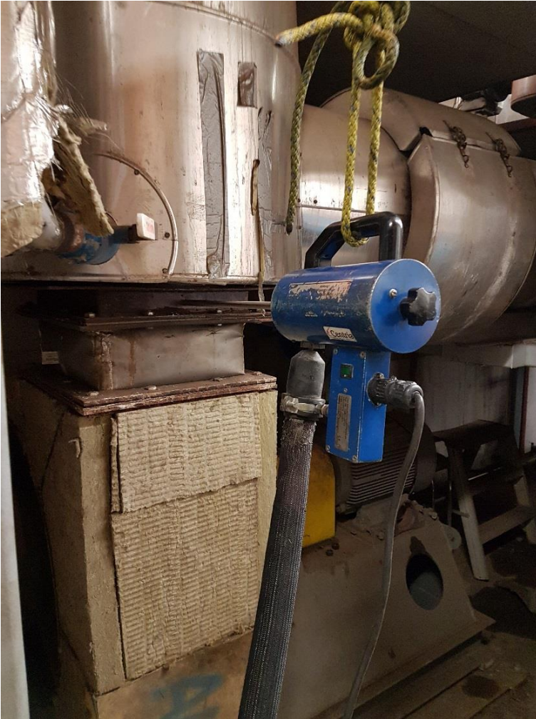
KUVA 13. Näytteenottosondi savukaasupuhaltimen painepuolen kanaalissa
