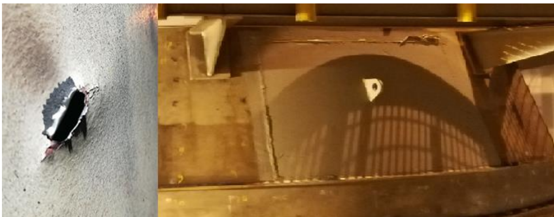
Kuva 16. Luokittimen kotelon kuluminen ja Hardox-korjauspala
