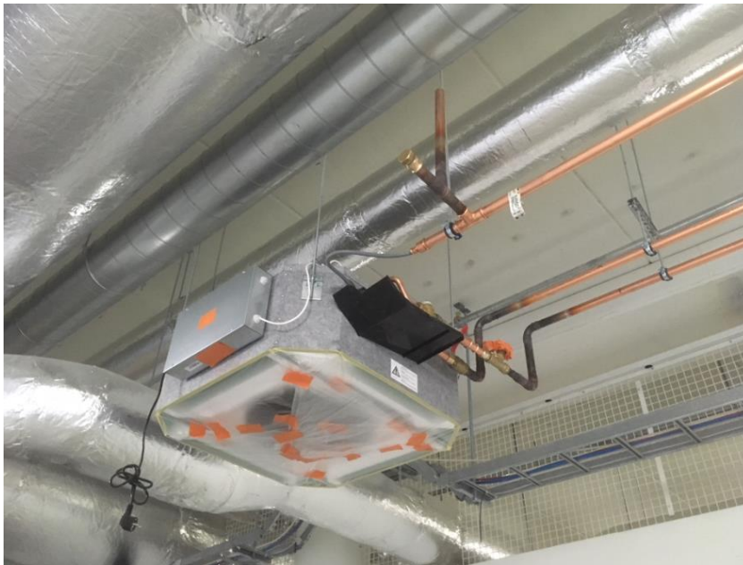
Kuva 28. Sabina SkyStar puhallinkonvektori asennettuna työmaalla.
