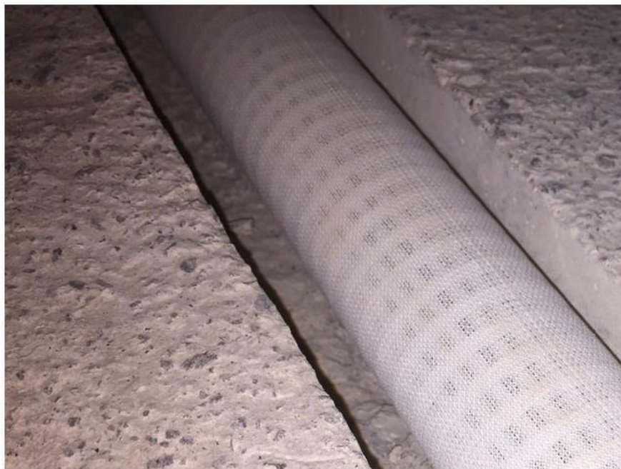
Kuva 17. SafeDrying® -kuivatusputki uratettuna lattiaan (www.safedrying.fi, 2018-03-17)
