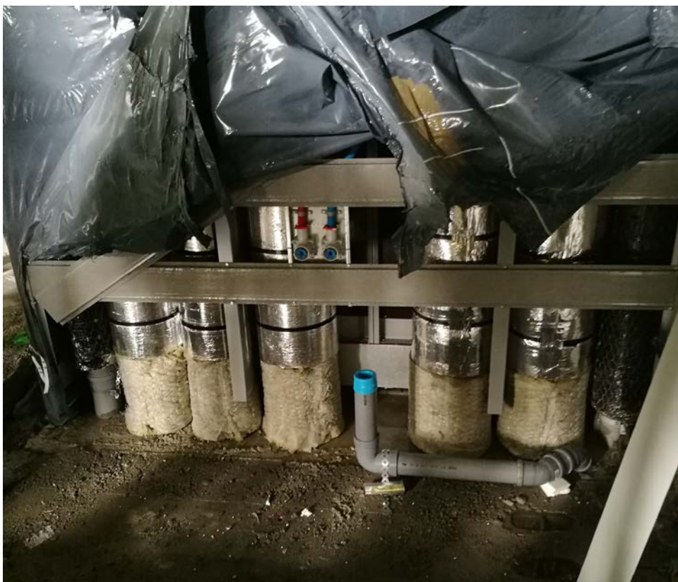
KUVA 13. Kosteutta on kertynyt kylpyhuone-elementin alle
