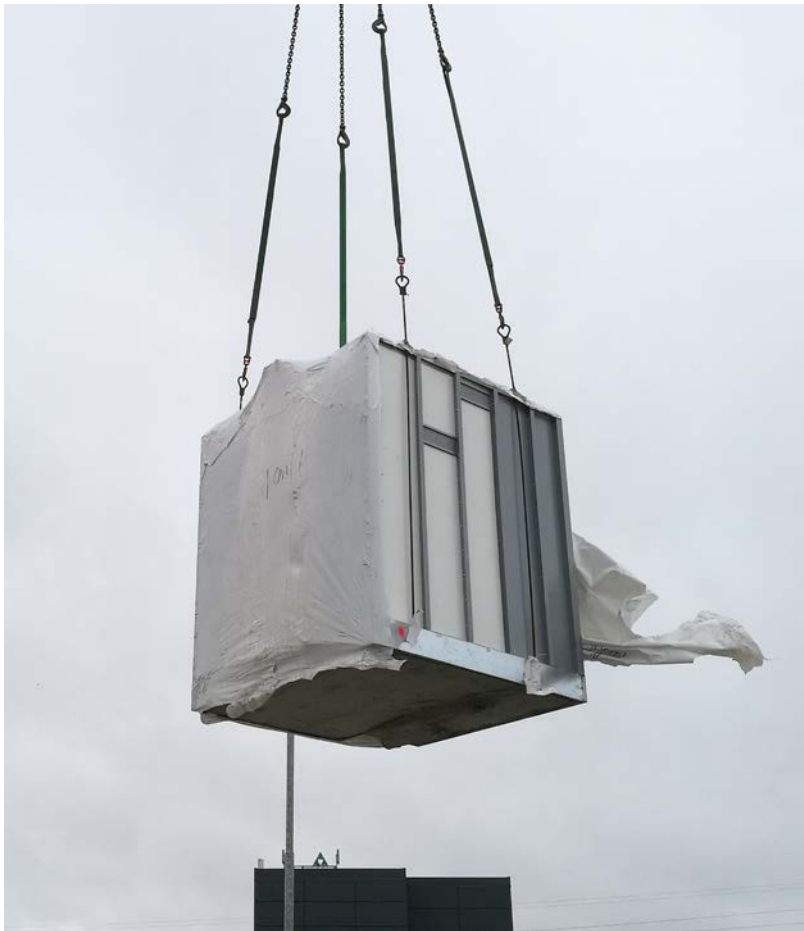
KUVA 14. Virheellisesti tehty suojamuovin leikkaus
