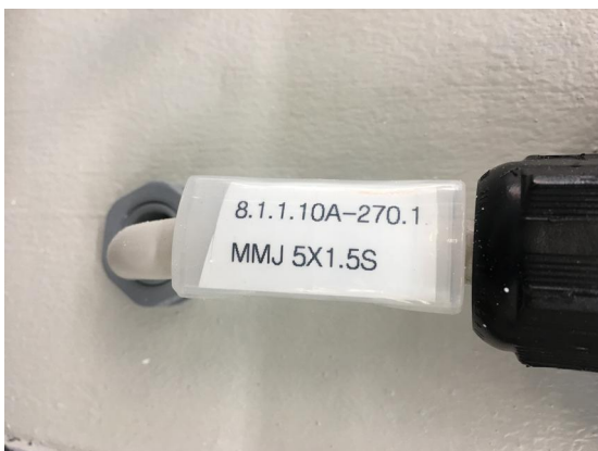
Kuva 4. Laitteen syöttöpiiri voidaan tunnistaa tästä kaapelimerkinnästä.
