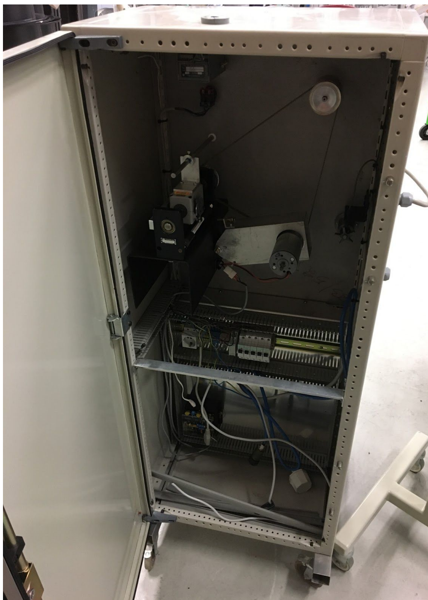
Figur 7. Hur skåpet såg ut med den gamla styrningen
