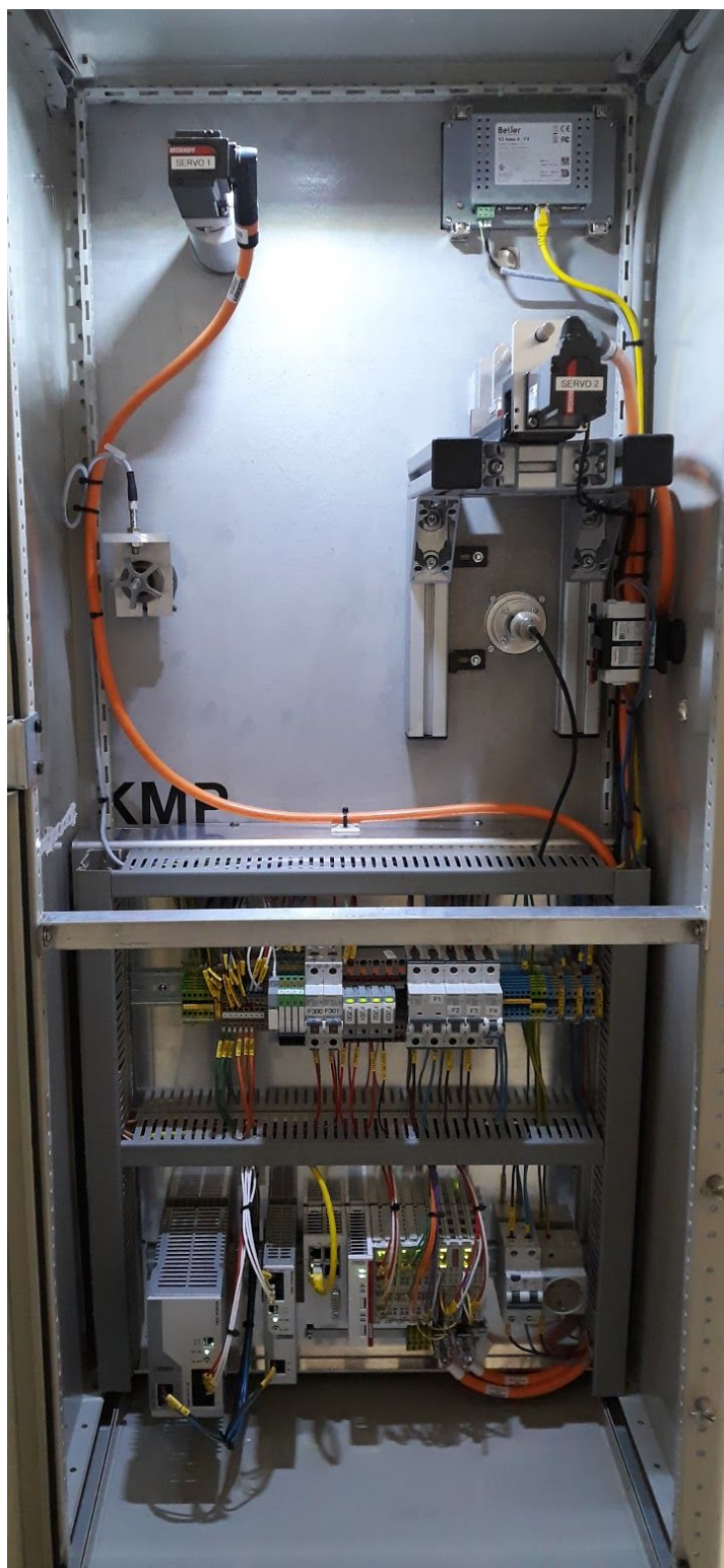
Figur 10. Elsystemet monterat och inkopplat samt båda servomotorer
