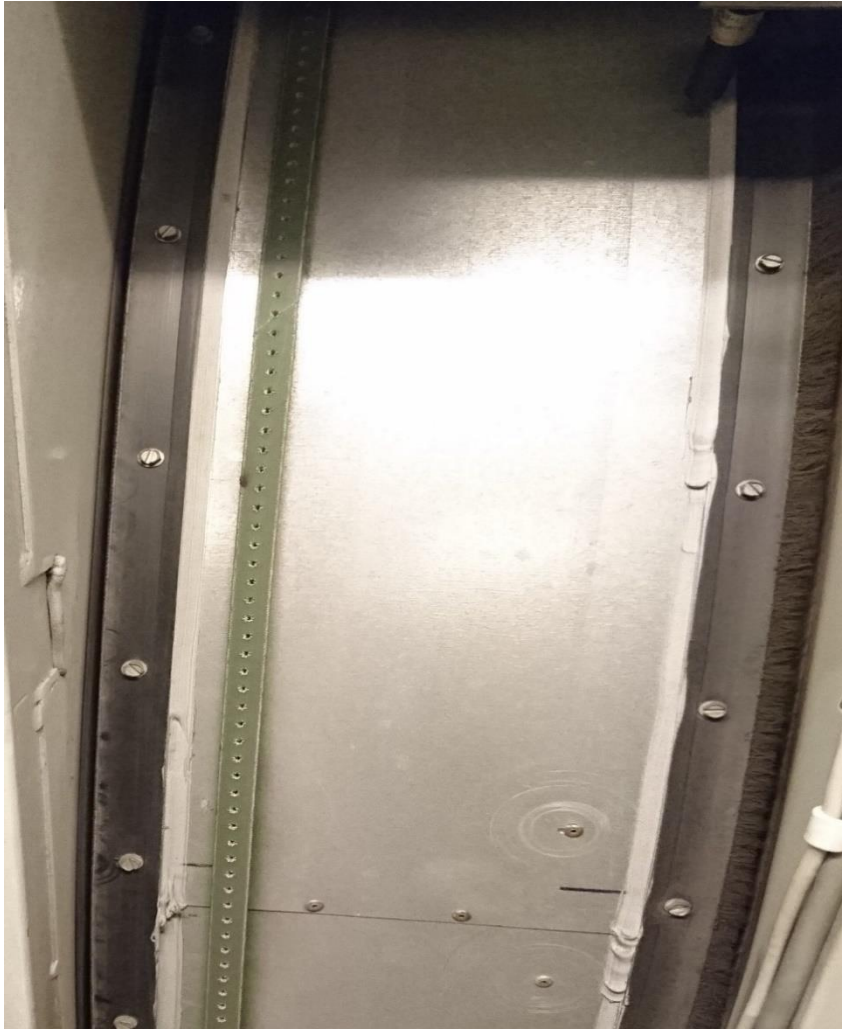
Kuva 3. LTO:n roottorin kulunut harjatiiviste.
