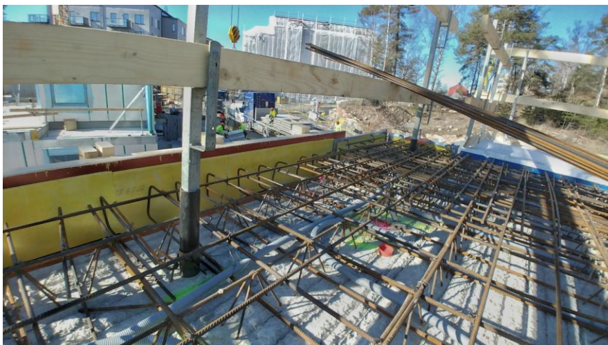
Kuva 17. Putoamissuoja filigran-välipohjaelementissä. Kuva: Sami Kotilainen 2018
