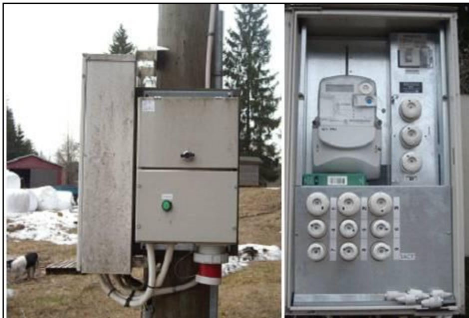
KUVA 24 Sähköpääkeskus, jossa päävirtakytkin ja aggregaatin liitin (Kivinen 2010).
