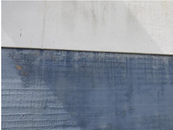
KUVA 5. Kosteus imeytynyt seinään
