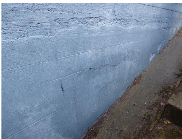
KUVA 4. Kalkkia rakenteessa. Maali päällä. Vettä vuotanut rakenteeseen
