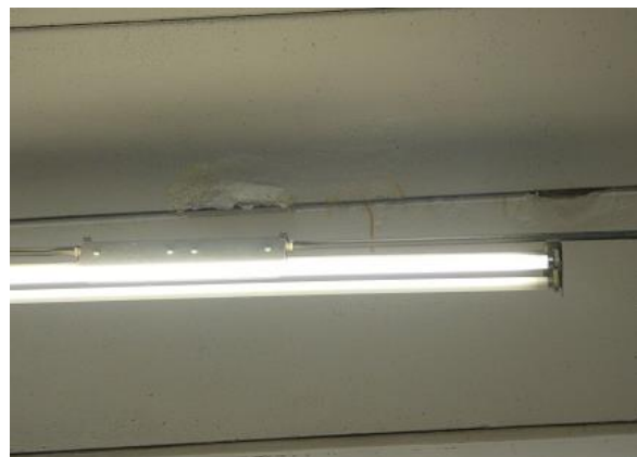
KUVA 22. Vuoto lämpölaitoksen katossa
