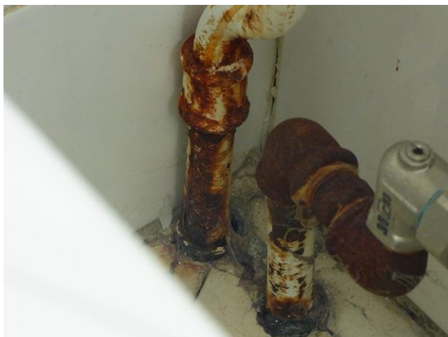
KUVA 31. Lämmitysputket asukastuvan WC:ssä
