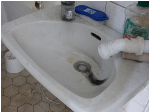
KUVA 33. Vesi- ja viemärikalusteet
