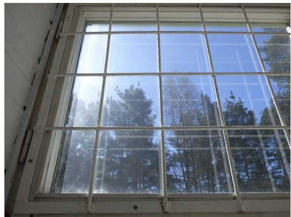
KUVA 14. Ikkuna asukastuvan WC:ssä
