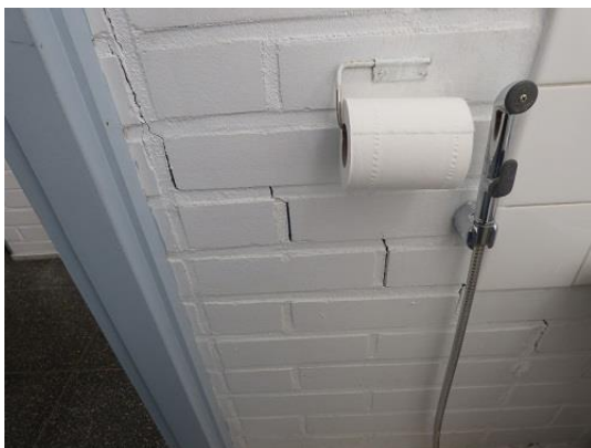
KUVA 7. Halkeama WC:n seinässä
