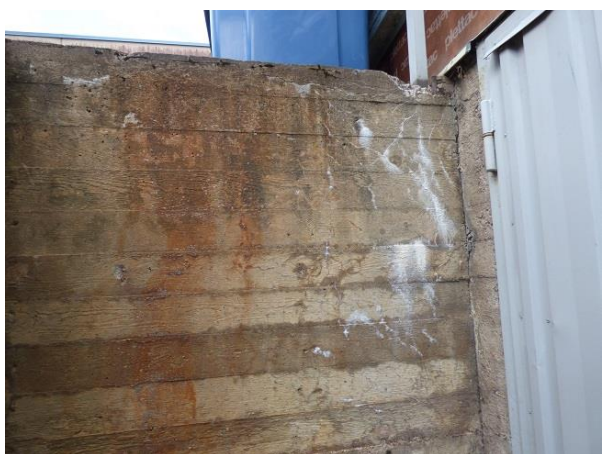
KUVA 3. Kalkkia rakenteessa. Vettä vuotanut rakenteeseen
