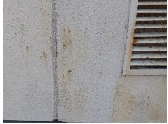
KUVA 10. Tiivisteiden kohdalla halkeama
