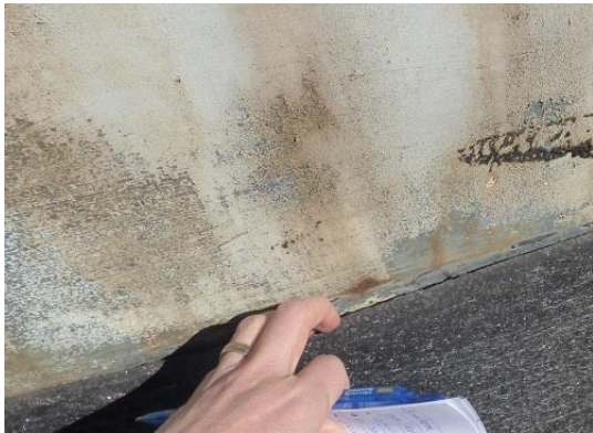
KUVA 20. Läpiviennistä bitumikermi irrallaan
