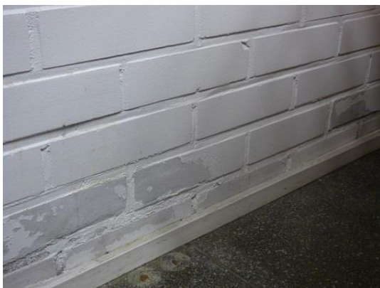
KUVA 24. Asukastuvan väliseinän maali irronnut
