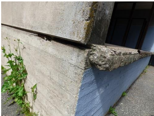
KUVA 11. Lastauslaiturin betoni rapautunut
