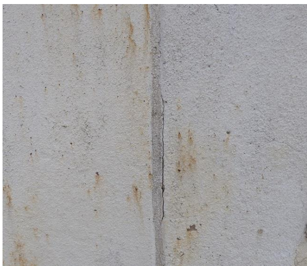
KUVA 1. Halkeama tiivisteiden kohdalla
