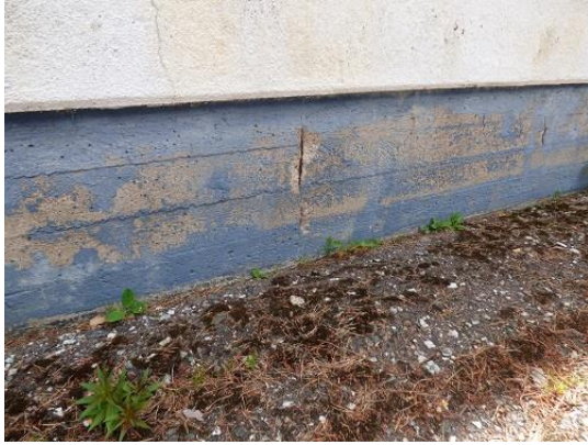
KUVA 9. Raudoituksen kohdalla betoni lohjennut
