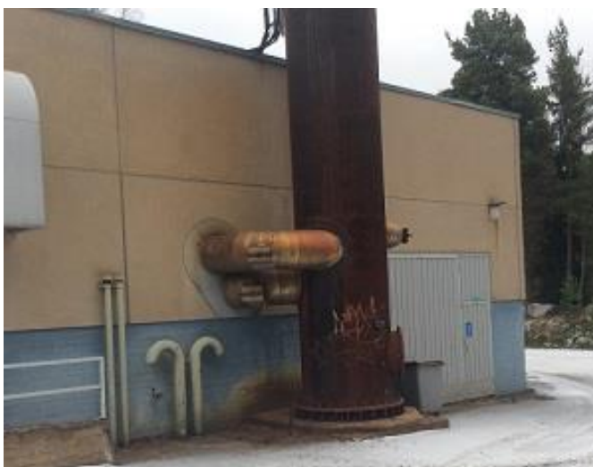
KUVA 6. Piipun juureen lammikoituu havaintojen mukaan vettä.
