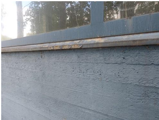
KUVA 15. Pohjoispuoleinen ikkunapelti. Maali huonokuntoinen
