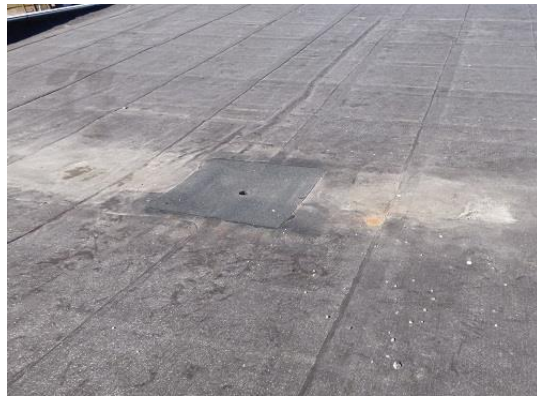
KUVA 18. Vettä ollut lammikoituneena kaivon reunoille
