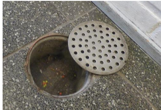
KUVA 34. Kuivunut lattiakaivo asukastuvan tiloissa
