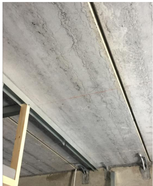
KUVA 7. Yläpohjan alapinta puhaltimien käytön jälkeen
