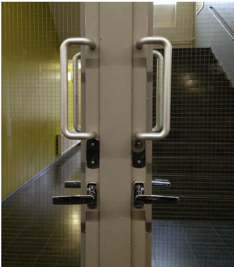
Kuva 23. D-siiven portaikon kahvat ensimmäisessä kerroksessa.
