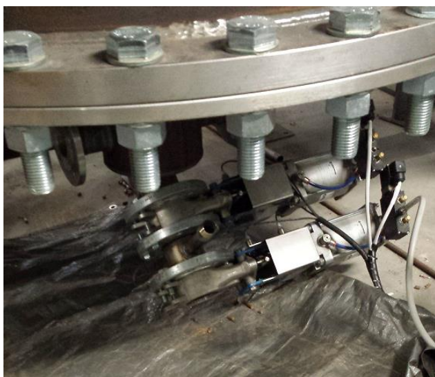
KUVA 14. Tuhkanpoistoyhde leijupetikattilan alaosassa.
