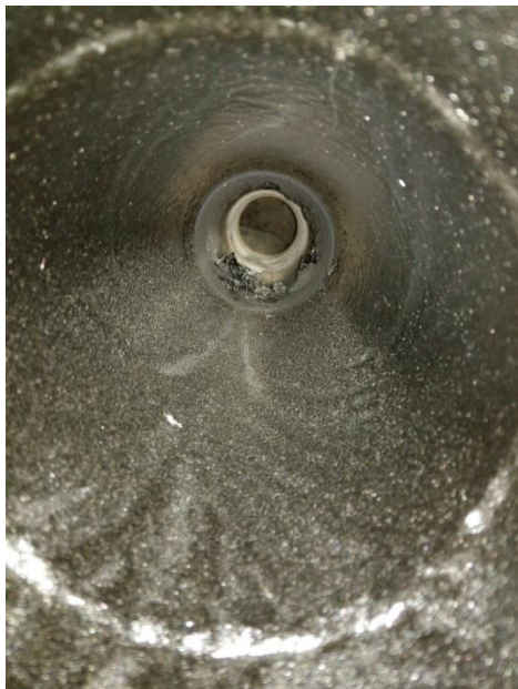
KUVA 35. Näkölasisyhteen putki. Havaittavissa tervaantumista.
