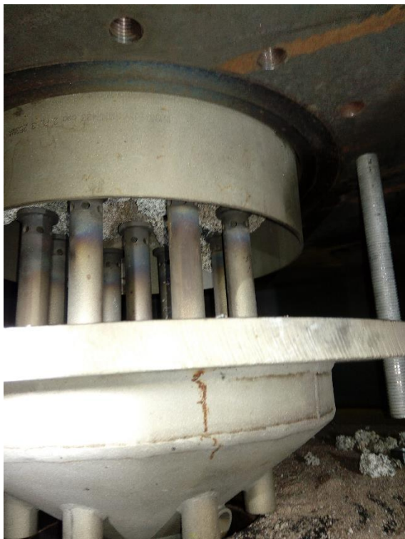
KUVA 24. Alas laskettu arina. Suutinten päällä näkyy harmaa sintraantunut kappale, joka porattiin iskuorakoneella kappaleiksi, jotta sen pystyi poistamaan kattilasta.
