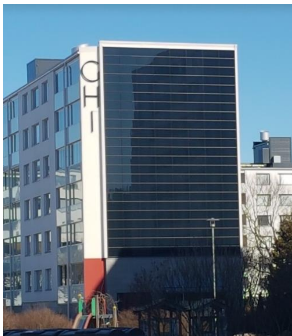
Kuva 9. Aurinkopaneelisto Turkulaisen kerrostalon seinäpintana. Huomaa läheisen rakennuksen aiheuttama alimman paneelirivin varjostus. Kuva Jussi Satokari 2018
