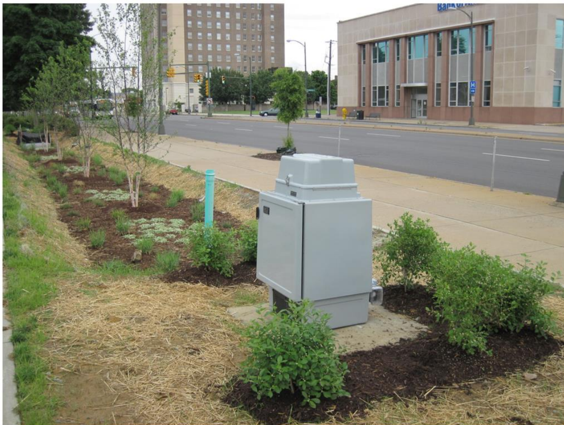
Kuva 2. Kaupunkiympäristöön rakennettu biosuodatuspainanne Virginian Richmondissa (Liu, Sample, Bell & Guan 2014.)
