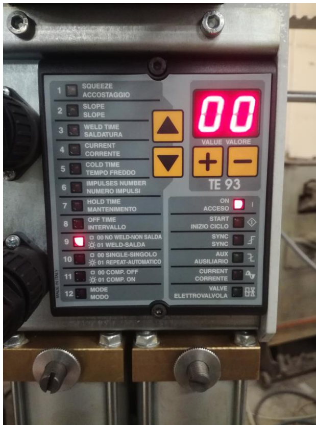
KUVA 9. Tecna pistehitsin ohjauspaneeli (Kuva: Ilkka Puska 2018)
