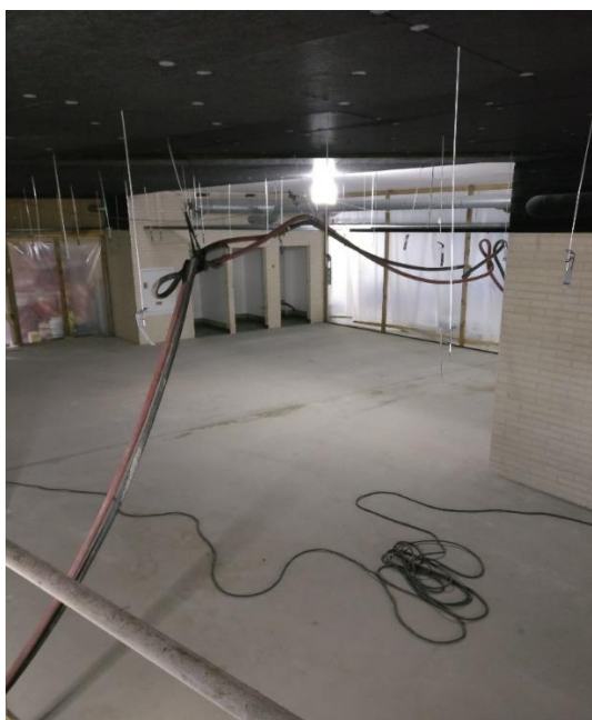
Kuva 3. Mesta ennen lattian avaushiontaan ryhtymistä.
