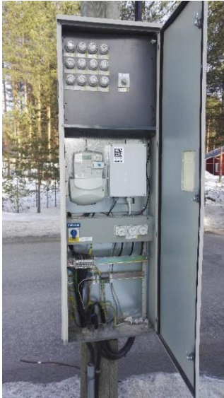
KUVA 4. Sorosentien kaappikeskus pylväässä.
