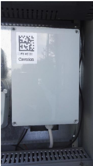
KUVA 13. Caverion ohjausjärjestelmän laatikko keskuksessa.
