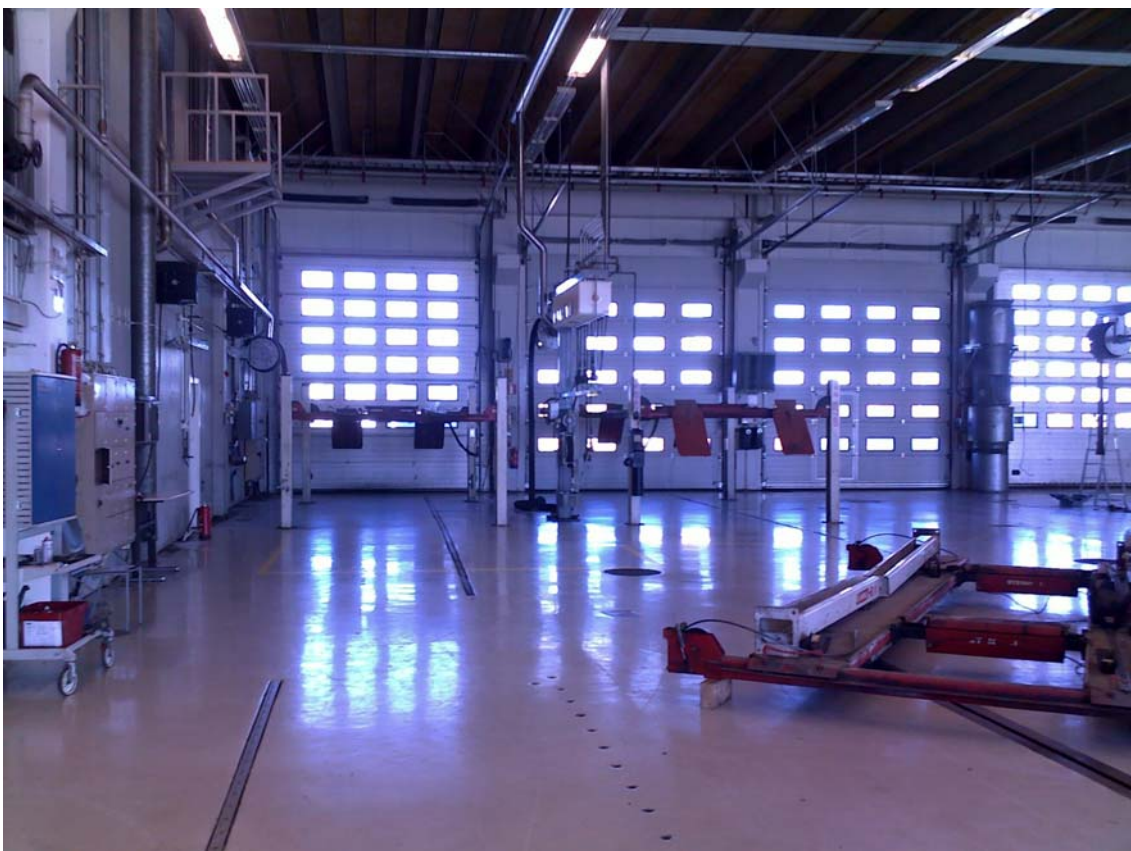
Kuvio 3 : Ensimmäiset ajosiltanosturit paikallaan. Vasemmalla ohjauskulmien säätöön käytettävä ajosiltanosturi.
