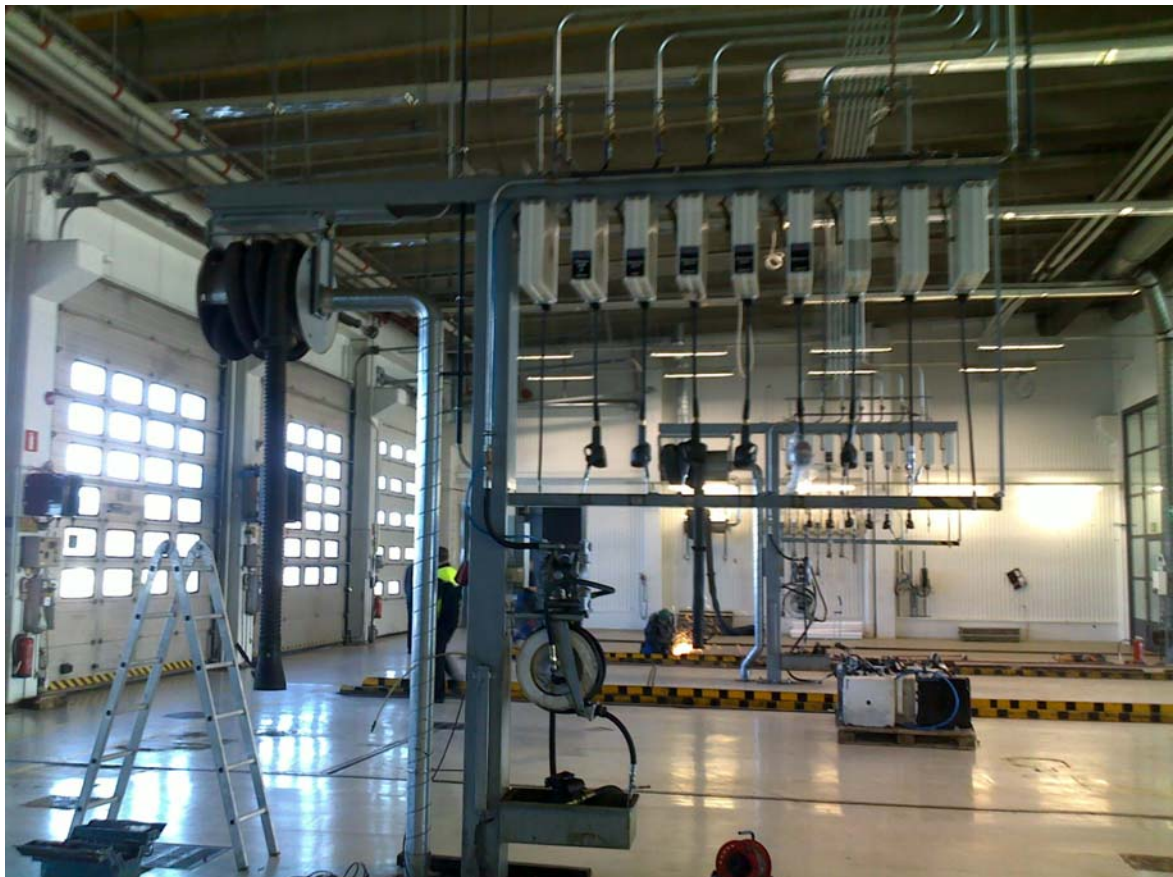
Kuvio 4 : Öljypiste, josta saadaan erilaisia öljyalaatuja, vettä ja paineilmaa. Alimmainen kela on öljyimuri ja vasemmalla roikkuva iso kela toimii pakokaasuimurina
