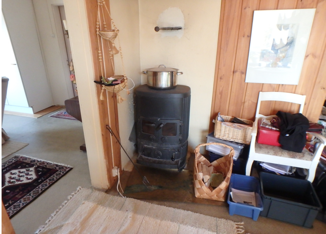
KUVA 20. Huoneessa oleva kamiina, jonka suojaus on kiinnittämättä
