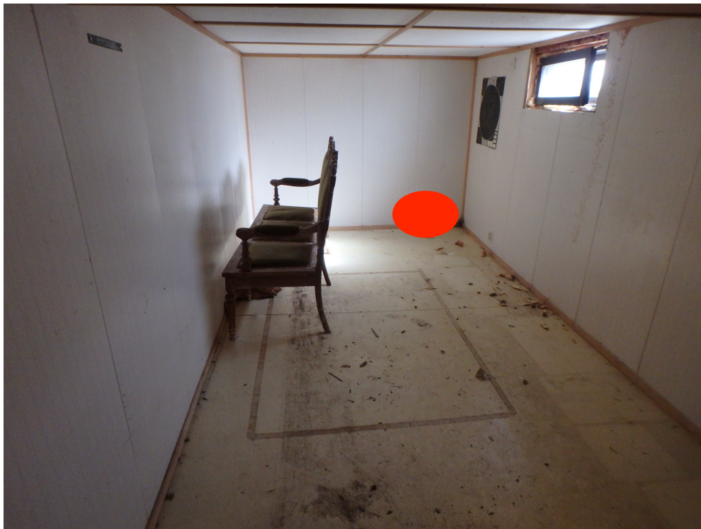
KUVA 16. Kellarin huone itäpäädyssä. Huoneessa kohonneita kosteusarvoja merkityllä alueella
