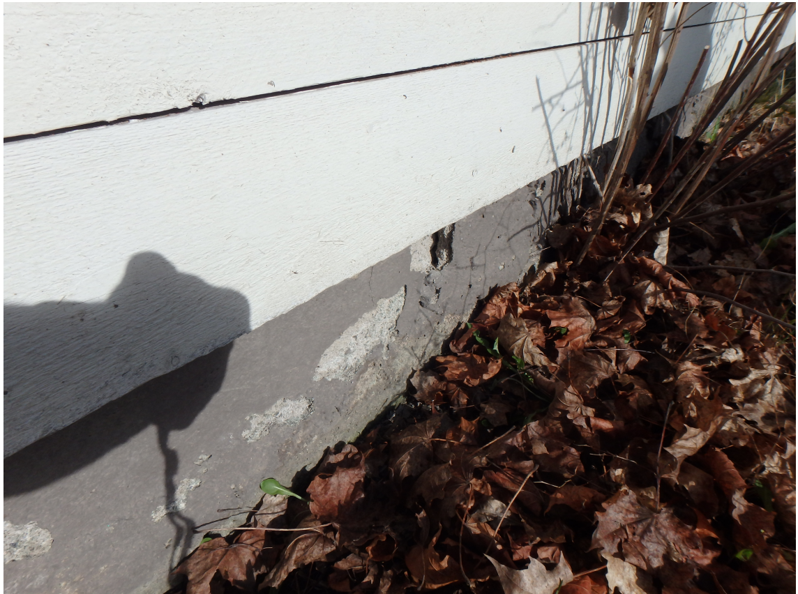
KUVA 8. Rappauksen irtoilu sokkelista sekä suurempi halkeama
