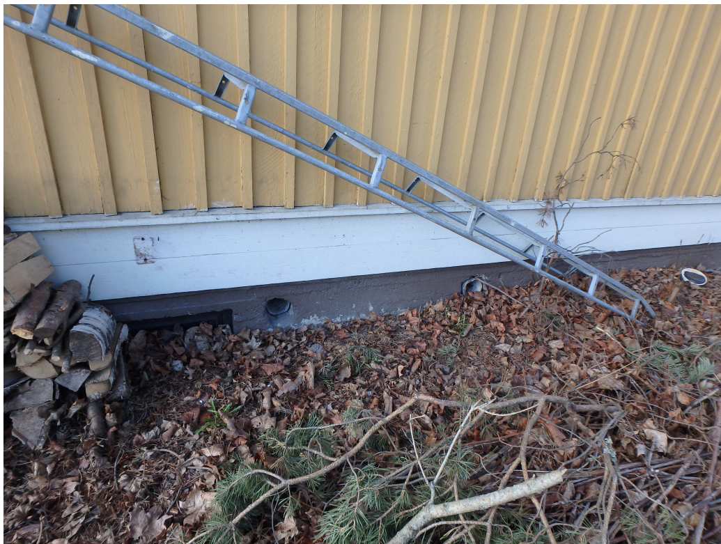
KUVA 14. Maanpinnan kallistus seinään päin ja kellarin ikkuna osittain maanpinnan alapuolella
