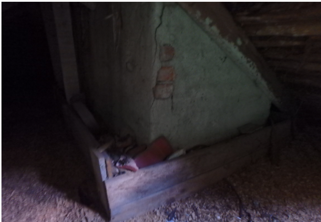
KUVA 11. Tiilimuurattu hormi ja rappaus halkeillut sekä paikoitellen irronnut
