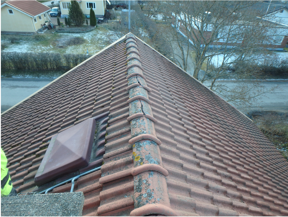
KUVA 10. Vesikatto, käyntiluukku yläpohjaan ja harjatiilet sekä niissä näkyvät halkeamat
