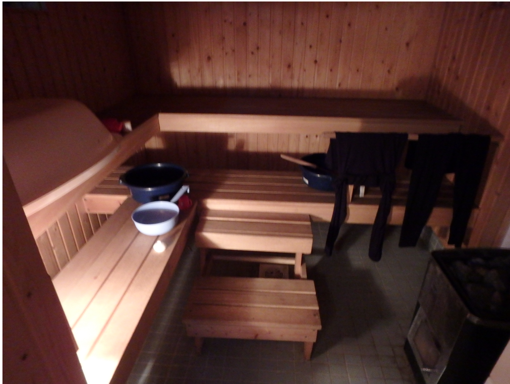
KUVA 19. Sauna. Lattian ja seinän liittymäkohdissa kohonneita kosteusarvoja
