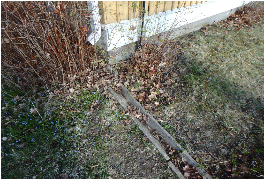
KUVA 14. Betoninen sadevesikouru painunut. Ei johda sadevesiä rakennukselta poispäin asianmukaisella tavalla
