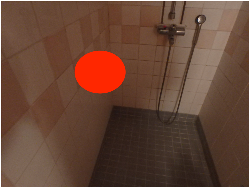
KUVA 18. Pesuhuone. Kohonneita kosteusarvoja merkityllä alueella
