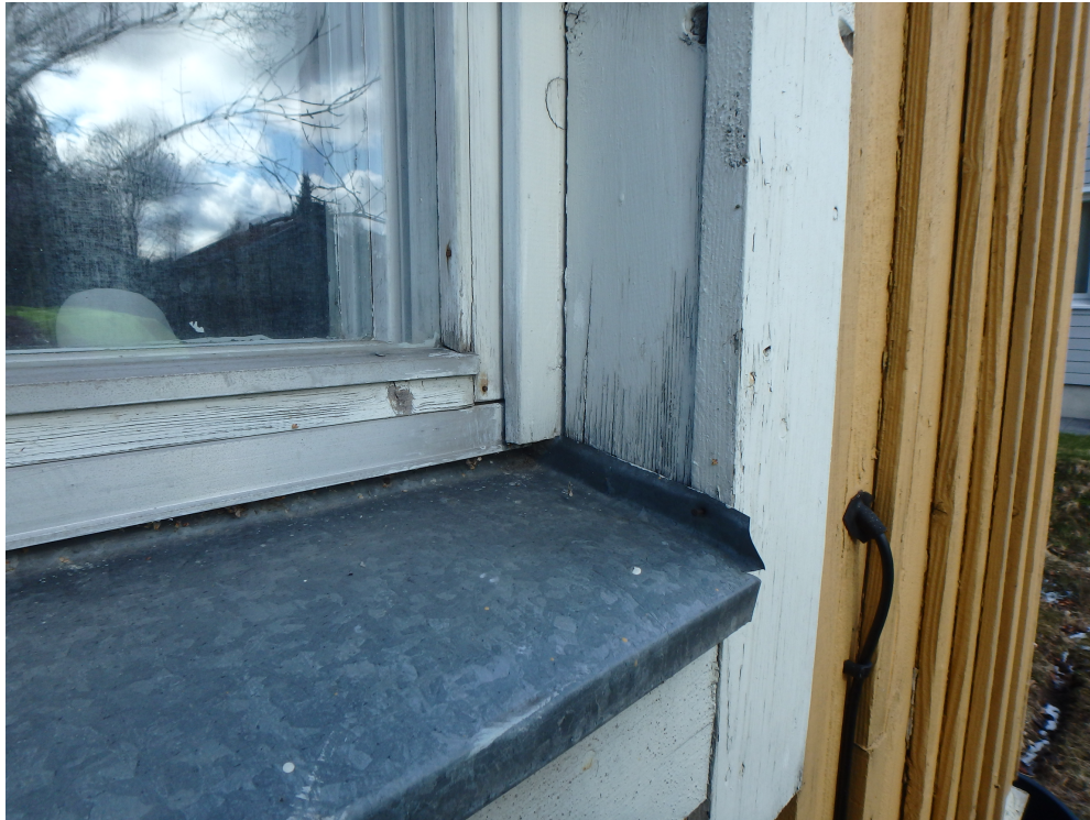
KUVA 12. Vesipellit hyvässä kunnossa. Pellin ja smyygilaudan väli tiivistämättä
