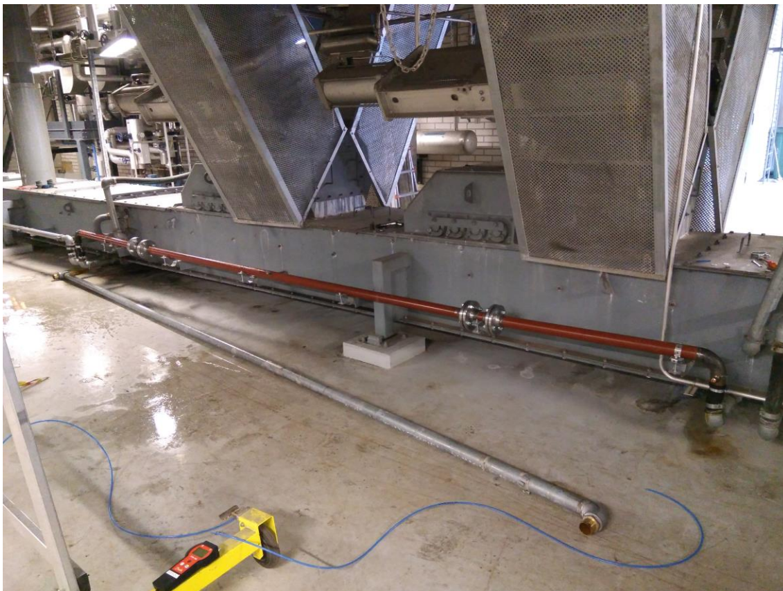
Kuva 8. Voxerin sisältämä putki asennettuna ja alkuperäinen putki. Kuvan vasemmassa alalaidassa Danfoss PFM100 mittalaite.
