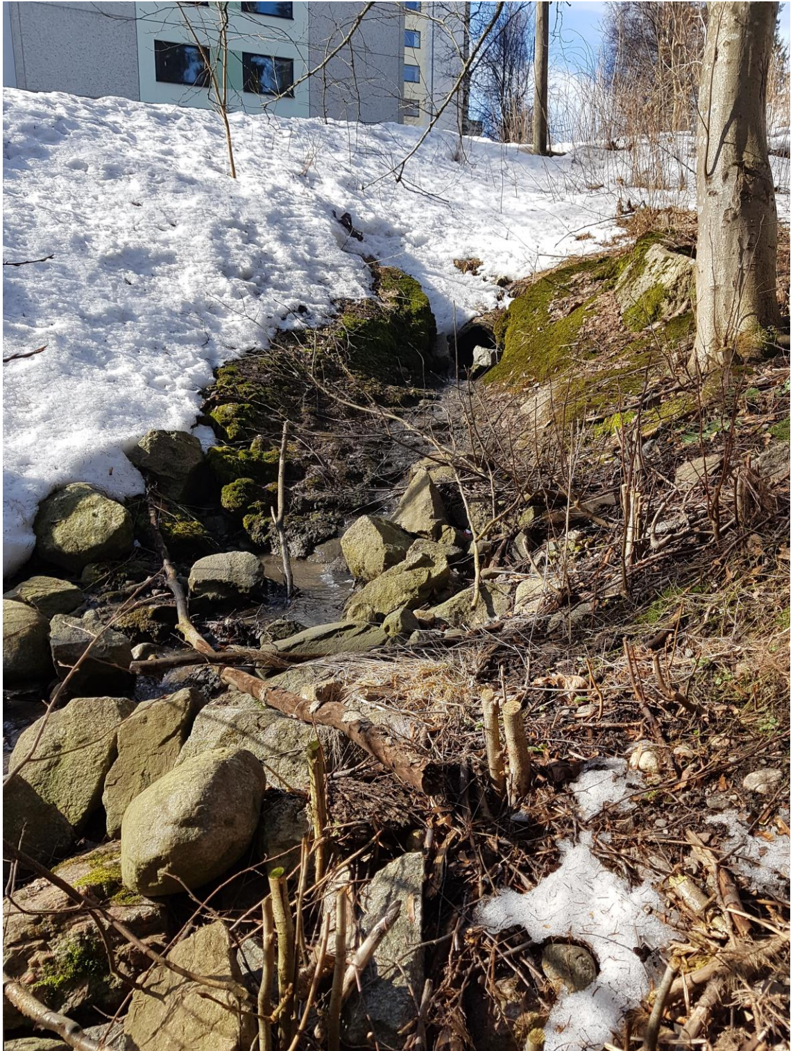
Kuva 4. Lahdessa 80-luvulla rakennetun kerrostaloalueen huleveden purkupaikka avo-ojaan.
