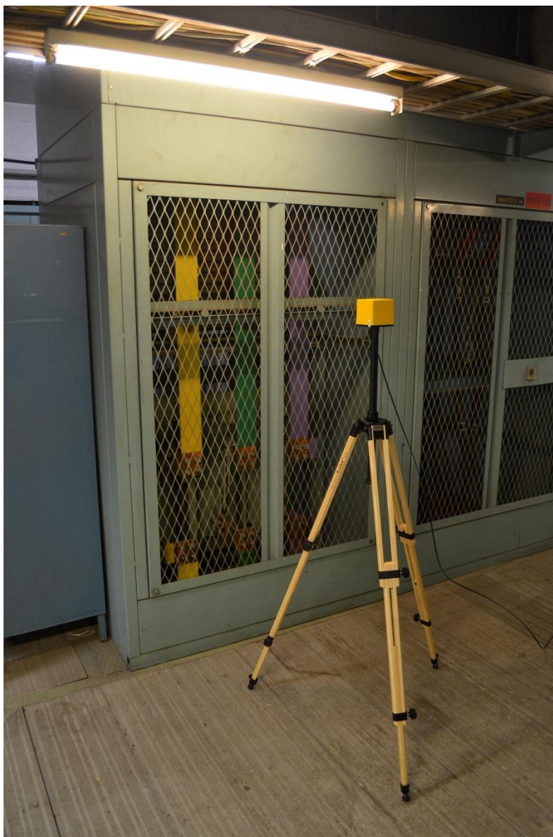
KUVA 12 10-kilovoltin kiskojen mittausta 1,5 m korkeudelta, 1,0 m etäisyydeltä. Pisteessä suoritettiin 3-pistemittaus.
