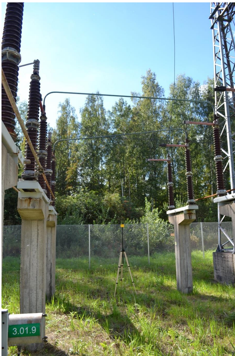
KUVA 14 110-kilovoltin voimajohtoja anturin yläpuolella. Mittakorkeus on kuvan tilanteessa 1,5 m.
