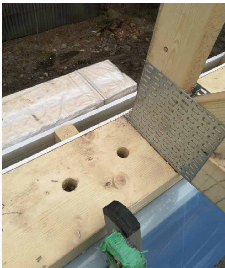
Kuva 4. Elementin puutteellinen suojaus
