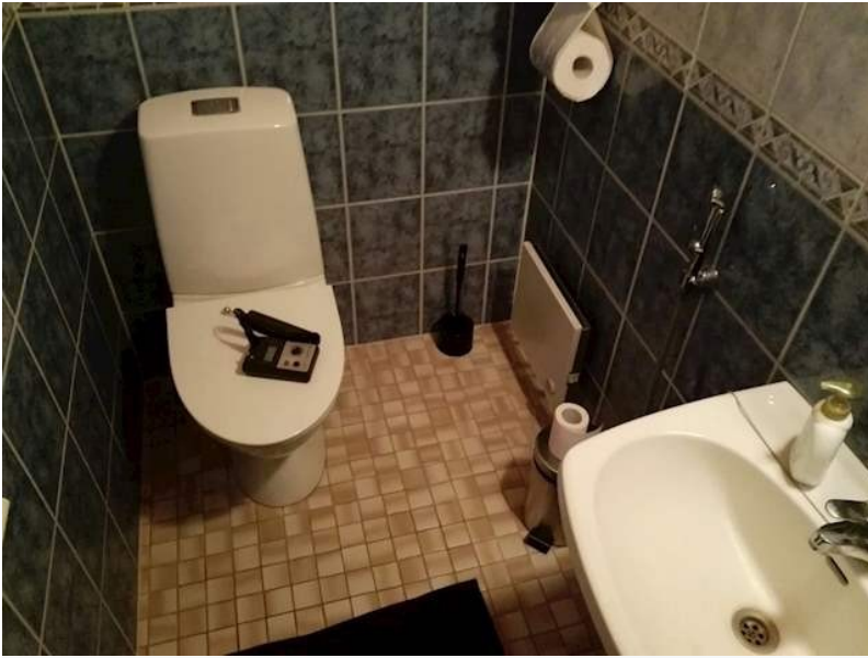
kuva yläkerran wc:stä missä vahinko tapahtunut
