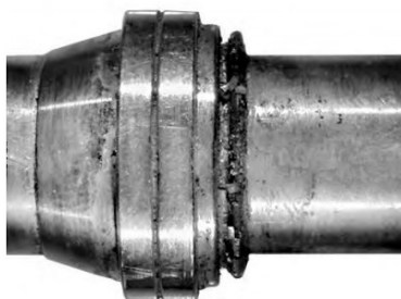
KUVA 3. Galvaanisen korroosion aiheuttama syöpyminen (Norwegian Oil and Gas Association 2013, 57)
