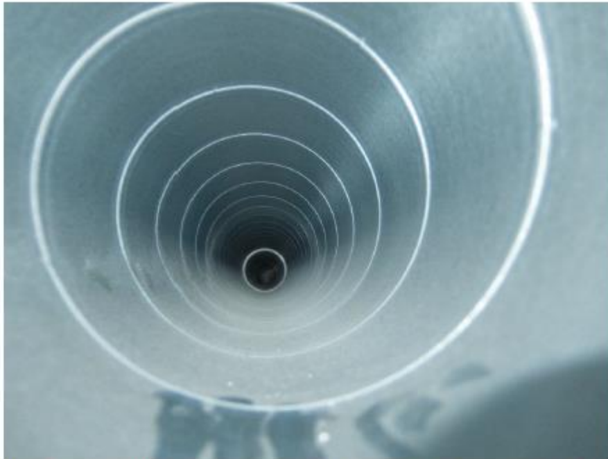
Kuva 8. Ilmanvaihtokanavien sisäpinoilla havaittiin olevan jonkin verran pölyä. Ilmanvaihtokanavien puhtauden arvioitiin tarkoitetun visuaalisen puhtausasteikon perusteella kuvan kanavassa oleva pölykertymä on noin 0,4 \text{ g/m}^2 . Kuva on otettu tilan 466 (Karvo) kohdalta tuloilmakanavasta. Mahdollisesti kyseistä kanavanosaa ei ole nuohottu vuonna 2015 tehtyjen nuohousten yhteydessä.
