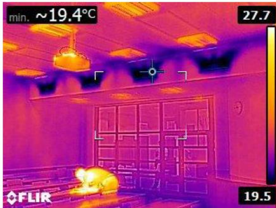
Kuva 6. Lämpökameran kuva luentosalin 146 (Ulappa) tuloilmaelimien kohdalta. Raitis tuloilma jää tuloilmaelimien lähetyville, mikä heikentää ko. tilojen ilmanvaihtuvuutta. Ilmanjakoa heikentää lisäksi tuloilman hieman liian korkea lämpötila. Ks. myös seuraava kuva samasta tilasta.
