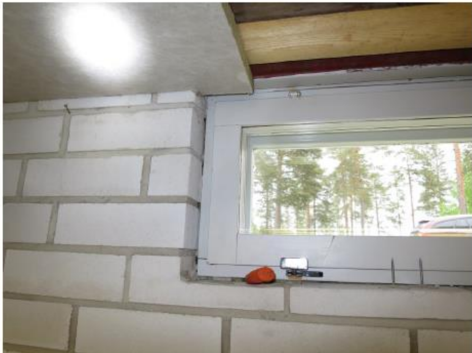
Kuva 7. Ikkunoiden tiiviyys. Ikkunoiden karmeissa huomattiin olevan rakoa, jotka tulee tiivistää.
