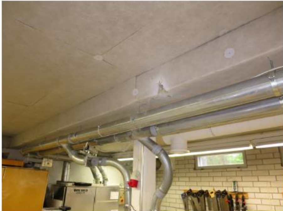
Kuva 6. Korvausilmakanavan kotelo. Savukokeella huomattiin kotelon olevan epätiivis, savua laitettiin korvausilmasäleikön päästä koteloon.
