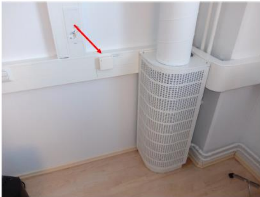
Kuva 5. Luokkahuoneessa 256 (Pauha) ilmanvaihdon tehoa ohjaava CO 2 -anturi on sijoitettu epätarkoituksenmukaisesti syrjäyttävän tuloilmaelimen välittömään läheisyyteen (noin 20 cm:n etäisyydelle), jolloin anturi mittaa hiilidioksidipitoisuutta käytännössä pelkästä raikkaasta tuloilmasta. Hiilidioksidianturi on merkitty kuvaan nuolella.
