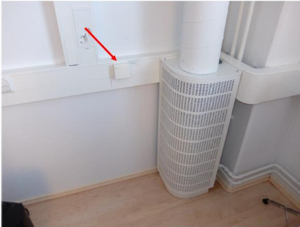
KUVA 4. Hiilidioksidianturi on asennettu tuloilmalaitteen läheisyyteen. Yliopistokeskus Chydenius, Kokkola. (16, s.15)
