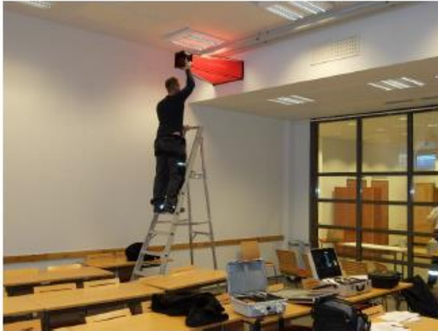
Kuva 3. Luentosaleissa 146 (Ulappa) ja 148 (Varvi) tuloilmaelimet ovat tavanomaisia käännettävillä suuttimilla varustettuja monisuutinhajottajia. Poistoilmaelimet sijaitsevat alakattokoteloinnin alapinnalla. Kuvassa on käynnissä ilmamäärien mittaus Swemaflow 125 D ilmamäärämittarilla.
