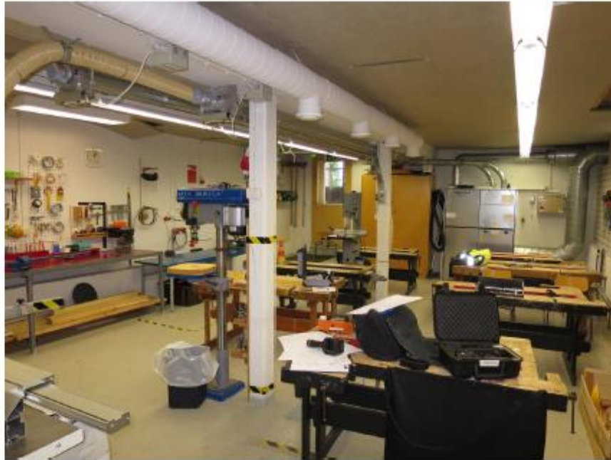
Kuva 8. Yleiskuva teknisen työn tilasta. Kuvassa näkyy tilaa palvelevan koneellisen poiston päätelaitteet.
