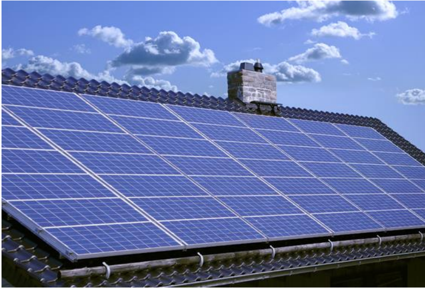
KUVA 14. Aurinkopaneeleita omakotitalon katolla (Keravanenergia.fi)
