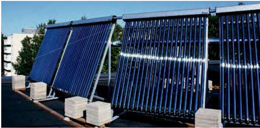
KUVA 17. Tyhjiöputkikeräimiä kerrostalon katolla. (Harmiton Oy)
