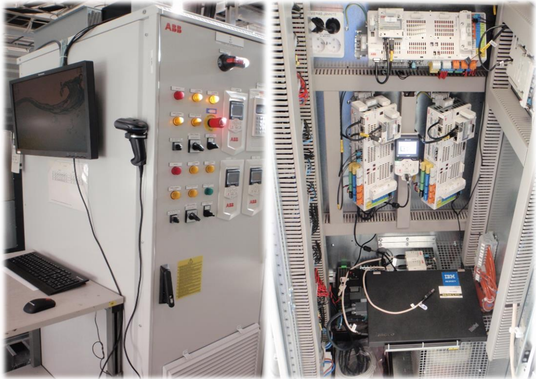
Kuva 2. Ohjauslaitteisto on tietokone ja BCU-ohjausyksikkö sekä LC8-linjan valintakytkimet
