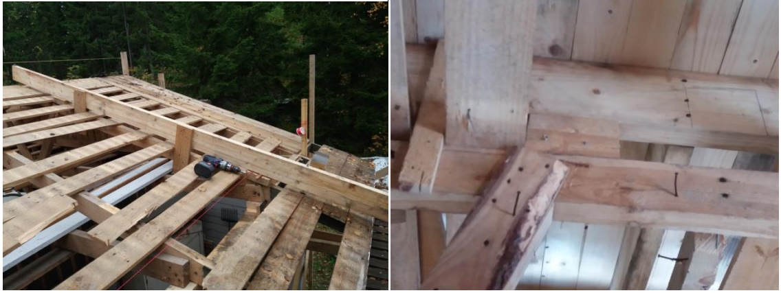
KUVAT 13 ja 14. Kattotuolien korotuspaarteet (Tuiremo 2017)
