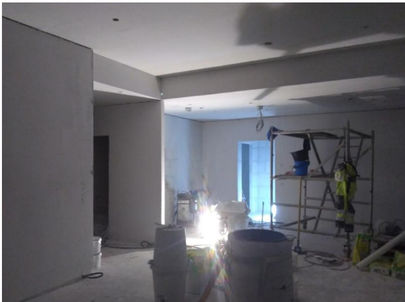
Kuva 34. Sisätilat ennen tasoitusvaihetta (ylhäällä) ja sen jälkeen, osa tasoitekerroksista on levitetty (pintatasoitteet puuttuvat). Talvi 2017.
