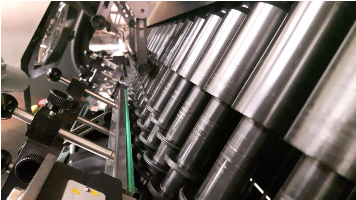
Kuva 3. Puoliautomaattisen tarkastuskoneen kuljetusrata ja -rullat.
