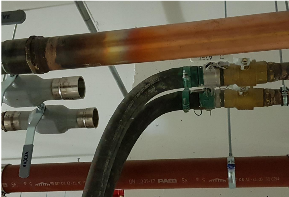
Kuva 24. 800 kW työmaa-aikainen kaukolämpökeskus yhdistettynä lopulliseen ylempiin kerroksiin menevään runkoputkeen kuuma-vesiletkuilla.
