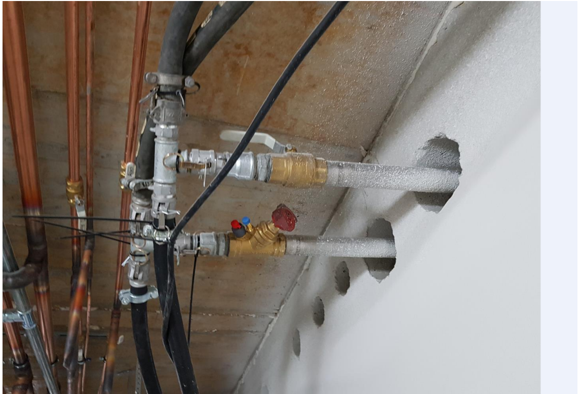
Kuva 26. Lämmittimille otettu haara pystylinjasta.
