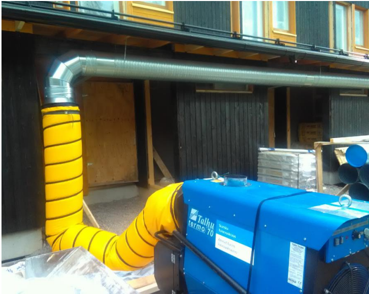
Kuva 14. Neljän asunnon rivitaloa lämmitetään yhdellä 70 kW tehoisella lämpöpuhaltimella.
