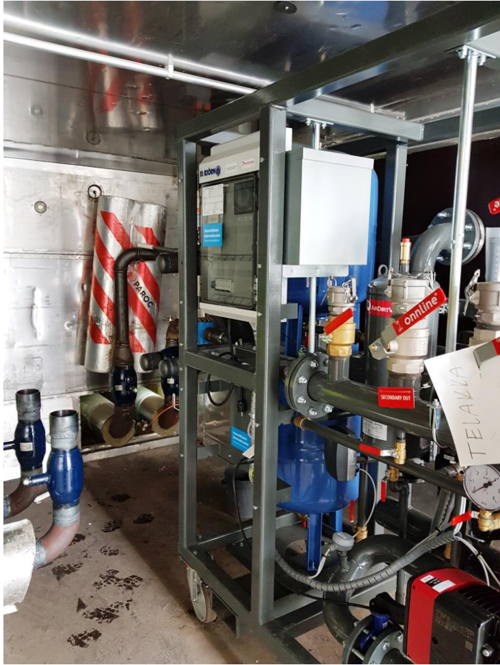
Kuva 20. 800 kW kaukolämpökeskus sijoitettuna konttiin työmaan ulkopuolelle.
