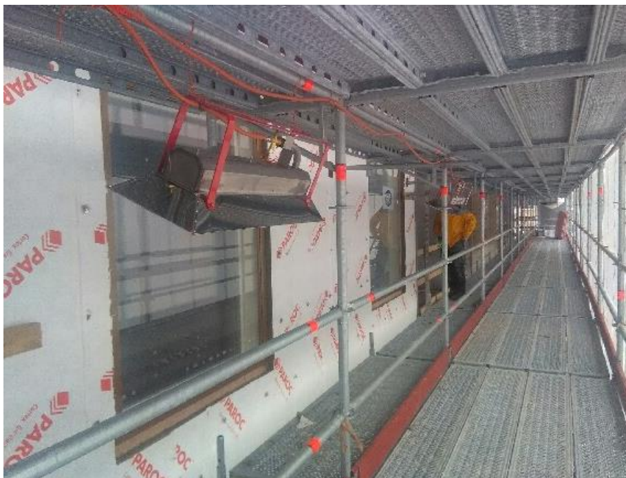
Kuva 36. 11 kW säteilylämmitin julkisivumuurauksessa.
