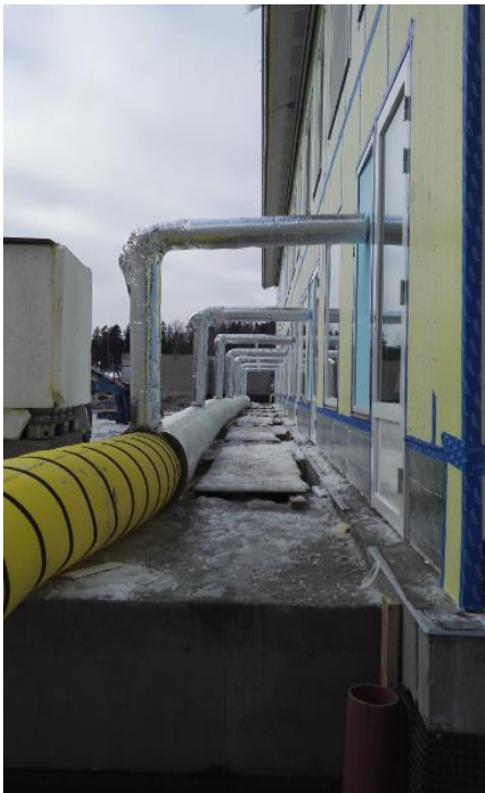
Kuva 15. Seitsemän asunnon rivitaloa lämmitetään yhdellä 195 kW tehoisella lämpöpuhaltimella.
