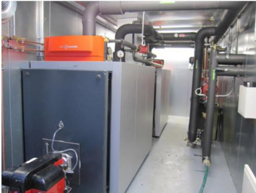
Kuva 23. 800 kW lämpökeskus (Skanska Konevuokraus Oy 2018).
