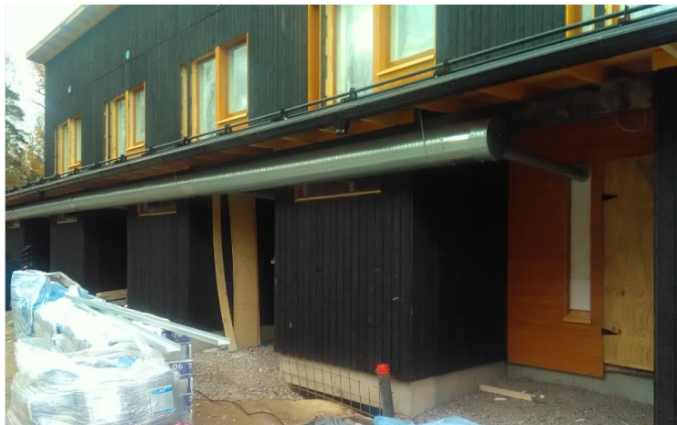
Kuva 13. Neljän asunnon rivitaloa lämmitetään yhdellä 70 kW tehoisella lämpöpuhaltimella.
