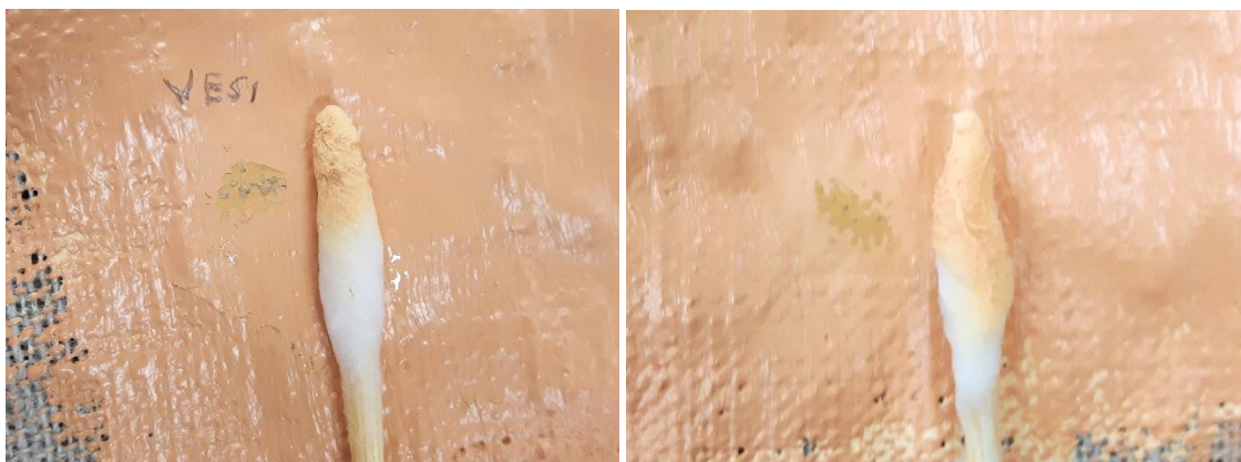
Kuvio 22. Liimamaali reagoi runsaan kosteuden kanssa, jolloin pinnalla oleva akrylaattimaali kuoriutuu pois (vasen kuva). Oikeassa kuvassa näkyy, kuinka etanoli liuottaa akrylaattimaalia ja alta paljastuu liimamaalikerros.
