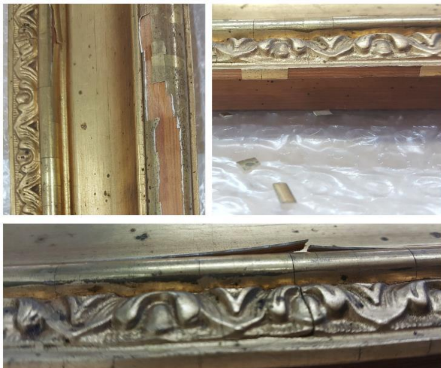
Kuva 7. Puun kutistumisesta johtuvaa pohjustuksen ja pintakäsittelyn irtoamista ja puutoksia.
