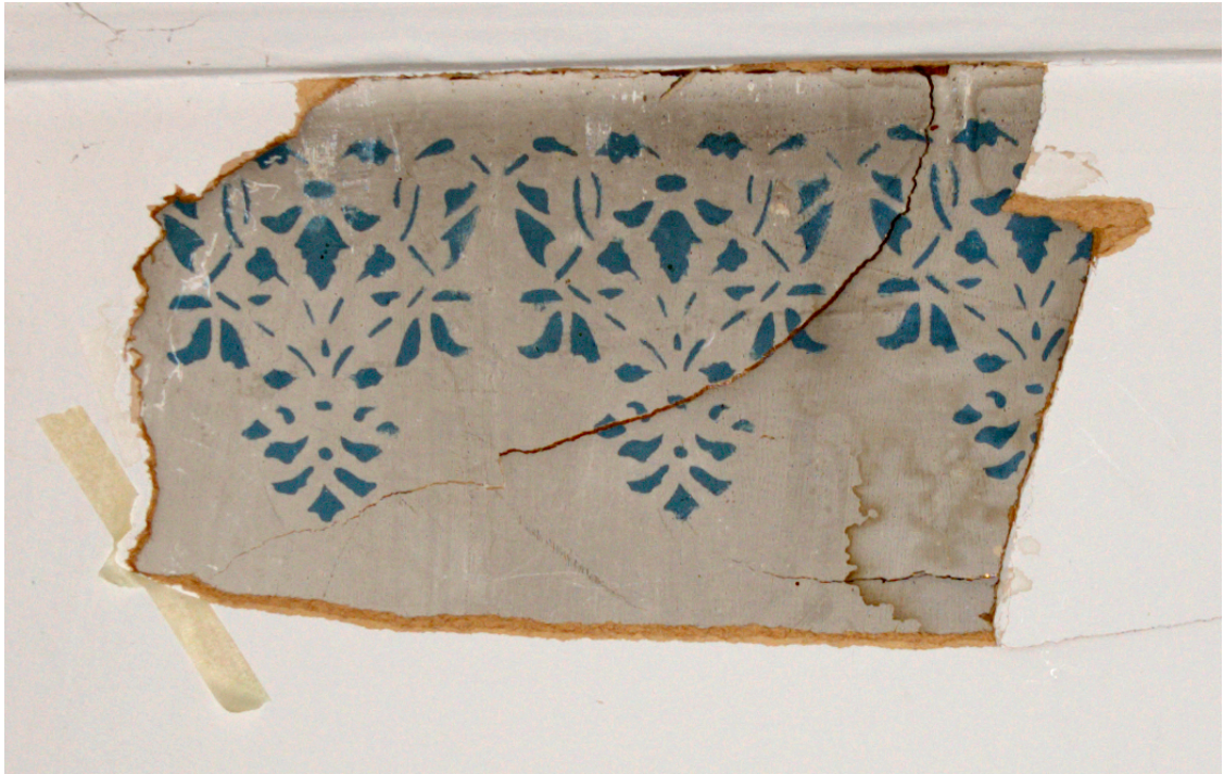
Kuvio 8. Näkyvässä olevan kattopahvituksen alla on alkuperäinen kattopahvi, jossa sininen sapluunakoristelu.
