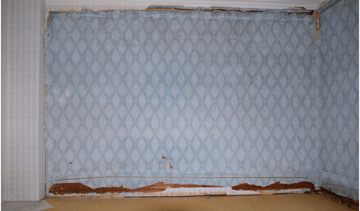
Kuvio 27. Seinäpinta ennen restaurointia.
