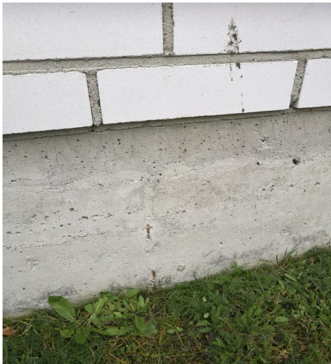
Kuva 4. Raudoitukset näkyvät sokkelissa.
