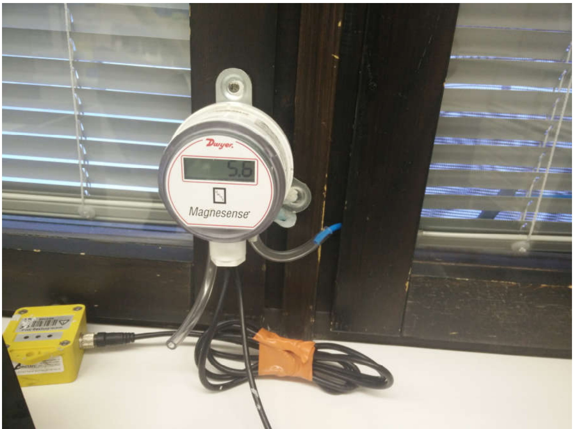
Kuva 18. Paine-eron pitkäaikaismittari asennettuna ikkunaan. Hetkellinen paine-ero näkyy näytössä.
