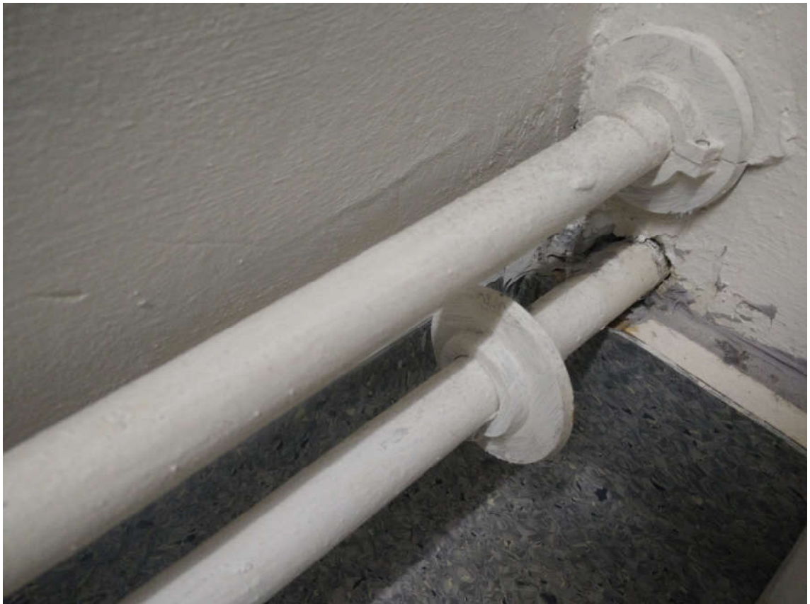
Kuva 42. Patteriputkien läpiviennit tulisi tiivistää paremmin, koska alapohjasta on ilmayhteys väliseinärakenteisiin ja läpivienneistä havaittiin runsaasti ilmavuotoa.
