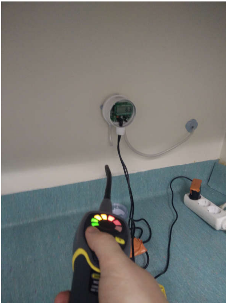
Kuva 38. Vuotoa havaittiin runsaasta ylipaineisuudesta huolimatta. Mittalaitteessa paine-ero seinän eristetilan ja sisäilman välillä 6,3 pascalia.
