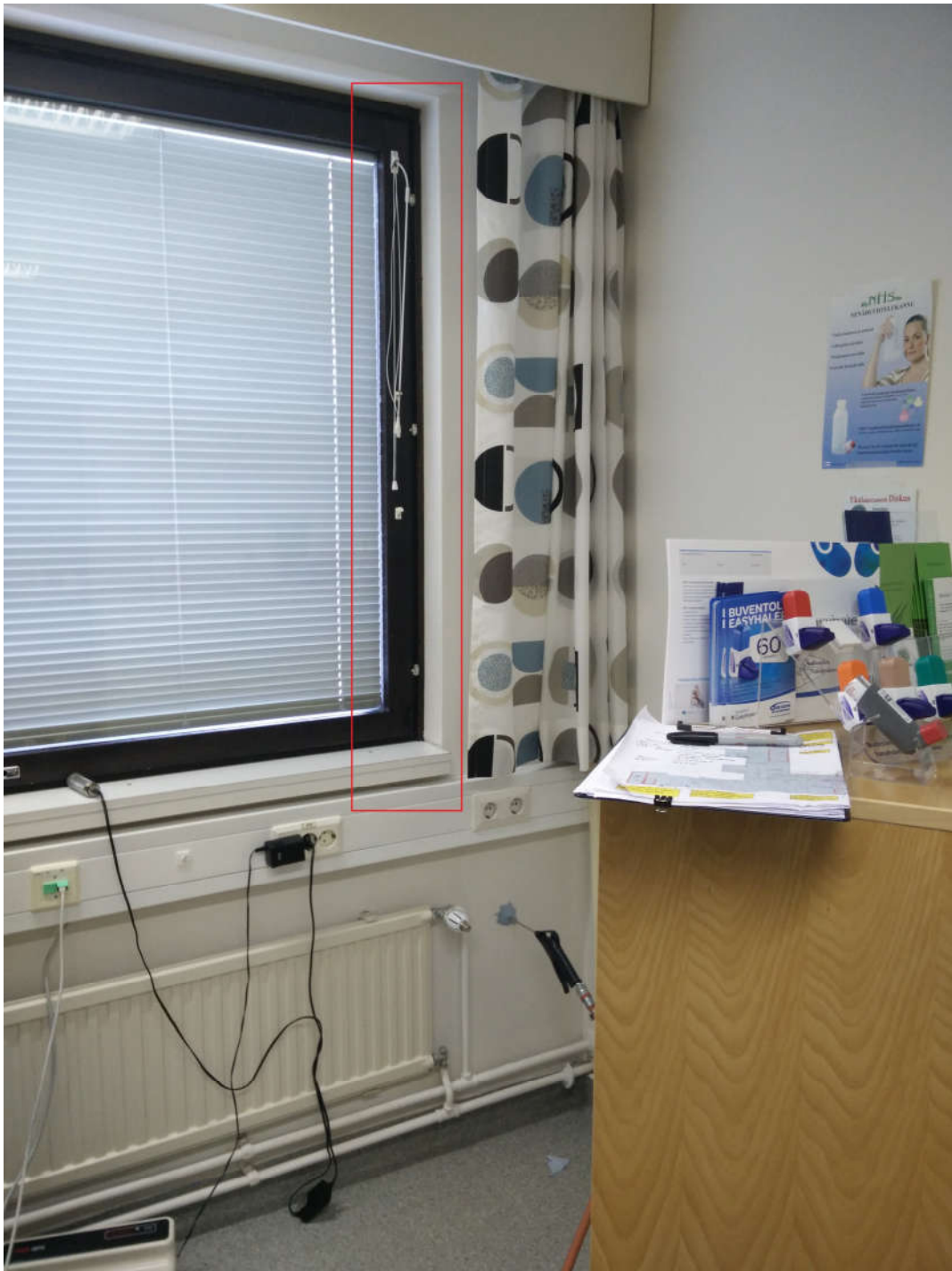
Kuva 29. Ulkoseinärakenteen merkkiainekokeessa havaittu vuotokohta
