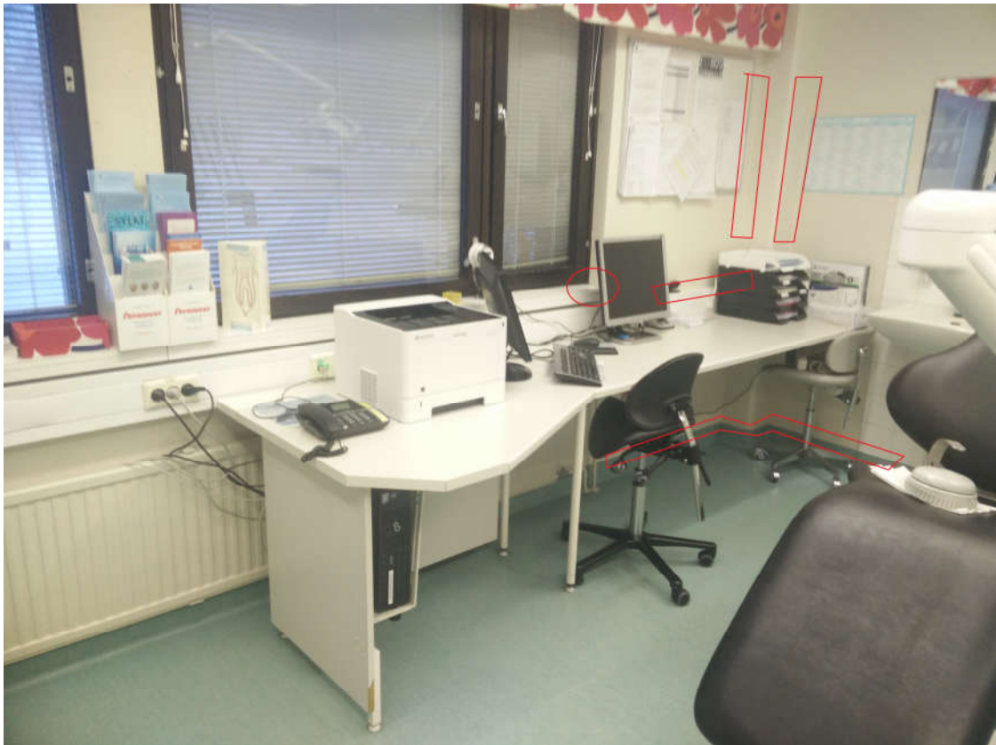
Kuva 40. Uusitussa merkkiainekokeessa havaittuja uusia vuotokohtia
