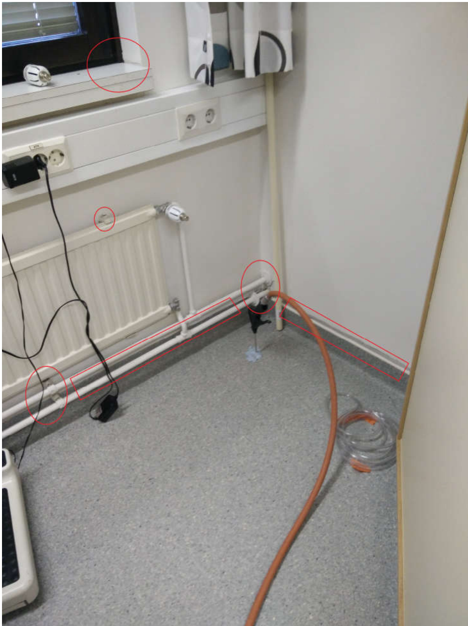
Kuva 28. Alapohjan merkkiainekokeessa havaitut vuotoilmareitit
