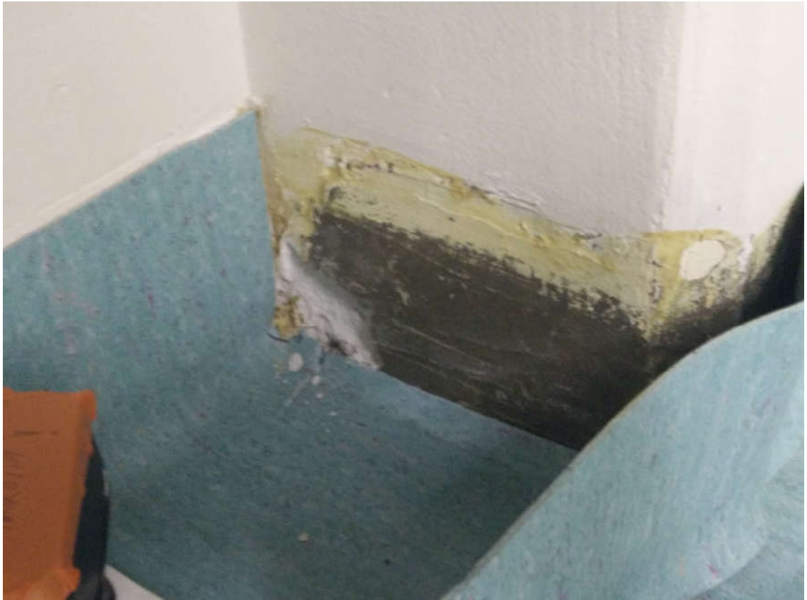
Kuva 41. Muovimaton ja ulko-/väliseinärakenteiden tiiveys oli paikoitellen hyvinkin puutteellinen. Kuvan muovimatto lähti irti sormenpäällä kevyesti vetämällä.
