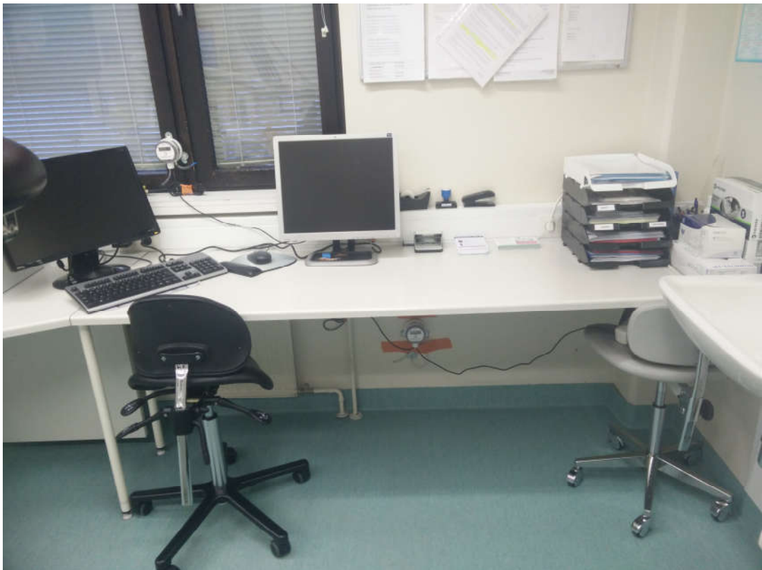
Kuva 30. Mittalaitteet asennettu ikkunaan ja pöydän alle tilassa 1.
