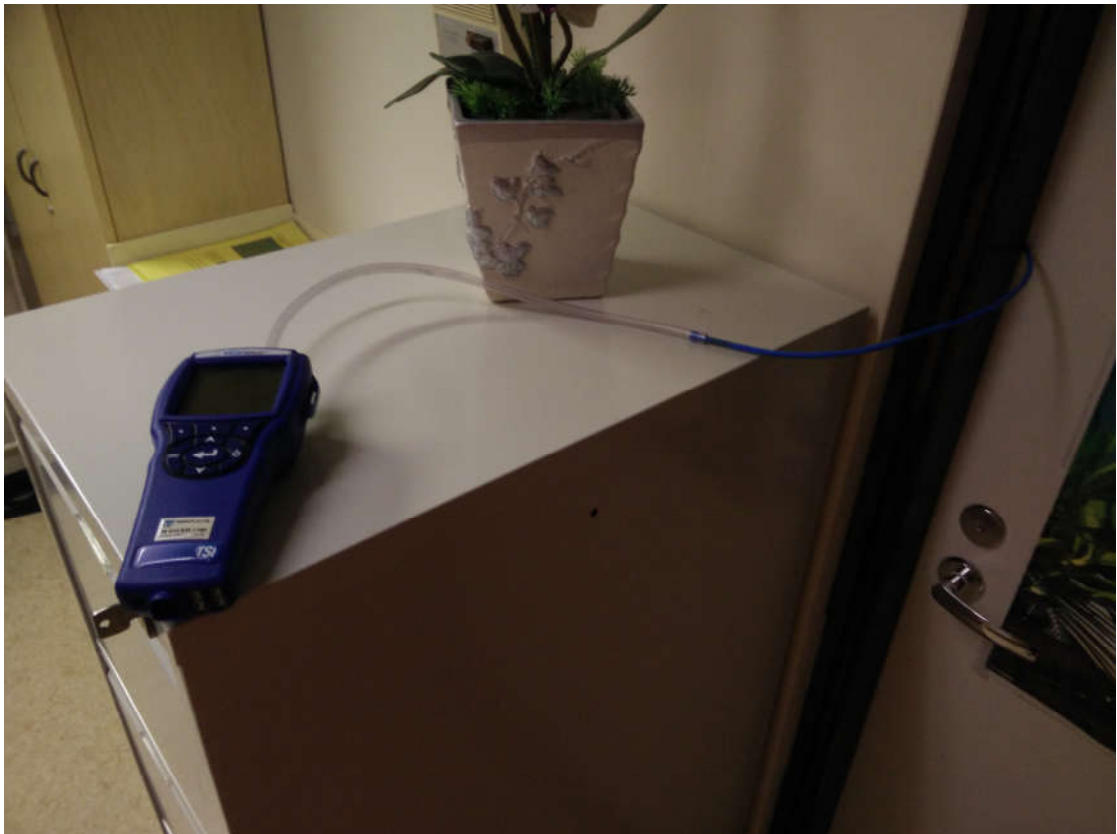
Kuva 14. Mittaus tiloja jakavan välioven osalta. Tila oli alipaineinen (-5 pascalia) viereiseen tilaan nähden runsaan poistoilmanvaihdon takia.
