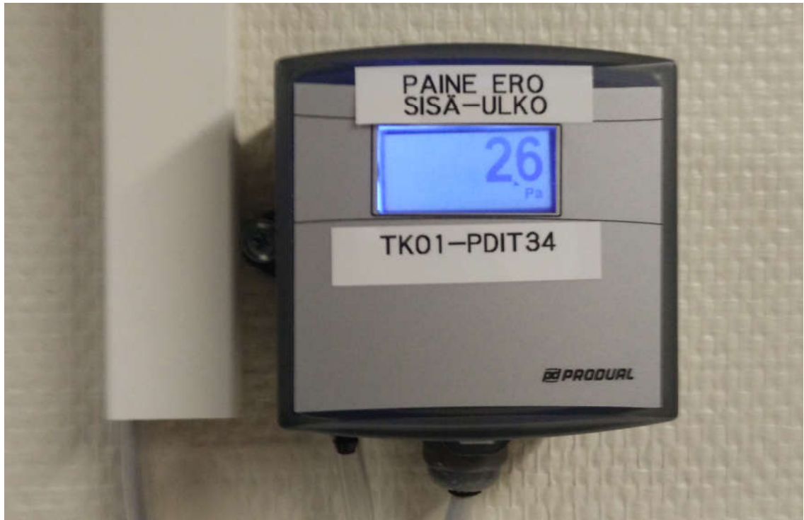
Kuva 9. Käytävälle asennettiin paine-eromittareita, joiden tarkoituksena oli antaa käyttäjille tietoa järjestelmän toiminnasta. Kuvaushetkellä sisäilman ja ulkoilman paine-ero on kuvassa +2,6 pascalia tuloilmakone yhden vaikutusalueella olevassa mittarissa.
