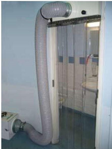
Kuva 2. Pölynhallintaovi, johon on yhdistetty tilan alipaineistus. [1, s. 204.]
