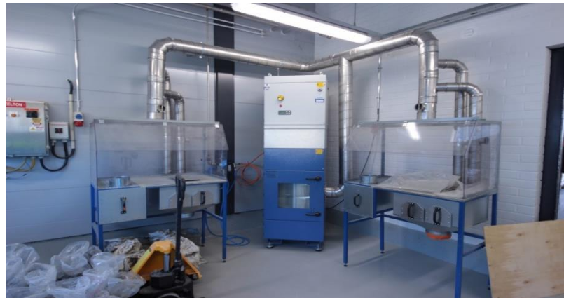
Kuva 9. Alipainetilan toimintaperiaate on sama kuin laboratoriossa yleisesti käytettävillä vetokaapeilla (Kohdepoisto 2018).
